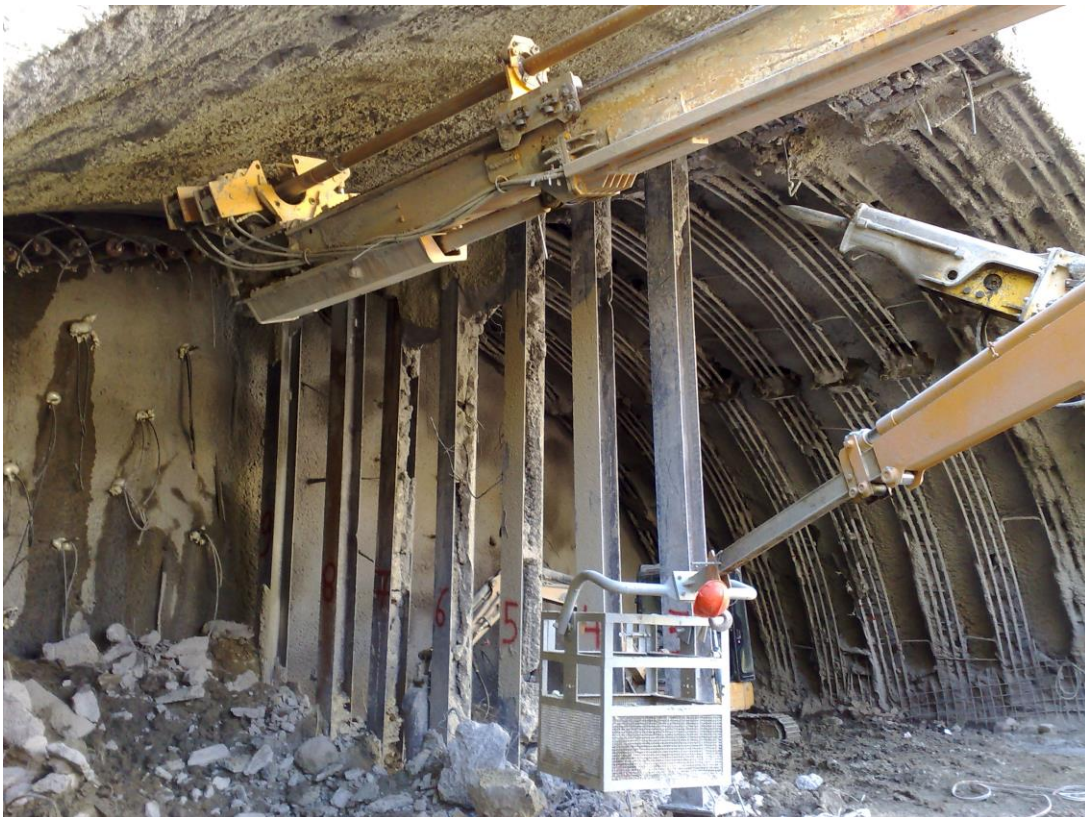
Μέτρα προσωρινής υποστήριξης (HEA ενδιάμεσου τοιχώματος, πλαίσια lattice girders, Forepoling, αγκύρια μετώπου fiberglass)
