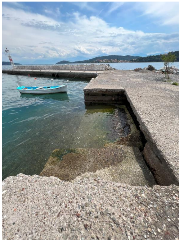
Εικόνα 5.22.6 Κατάρρευση τμήματος κρηπιδώματος του δυτικού βραχίονα
