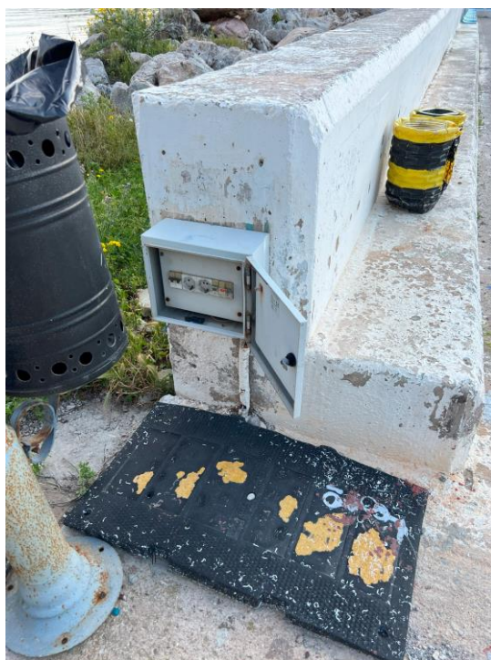
Εικόνα 5.17.2 Ερμάριο ηλεκτρικού πίνακα φωτισμού με δύο θέσεις ρευματοδότη
