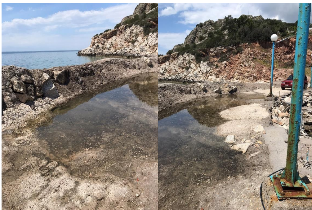
Εικόνα 5.8.9 Κατακράτηση όμβριων υδάτων επί της ανωδομής του προσήνεμου μώλου
