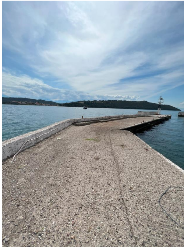
Εικόνα 5.22.5 Ρωγμές στην ανωδομή του ανατολικού βραχίονα
