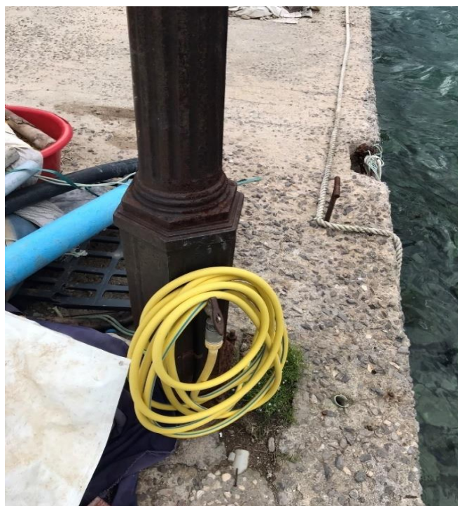
Εικόνα 5.3.5 Παροχή ύδρευσης επί του ιστού φωτισμού
