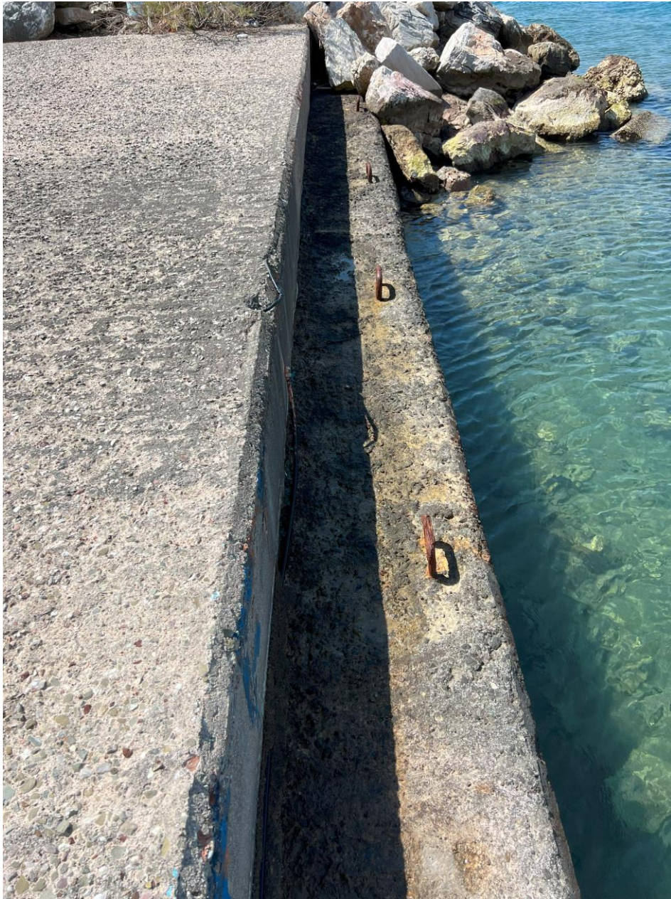
Εικόνα 5.26.7 Ρήγωση πλησίον ακρομώλιου
