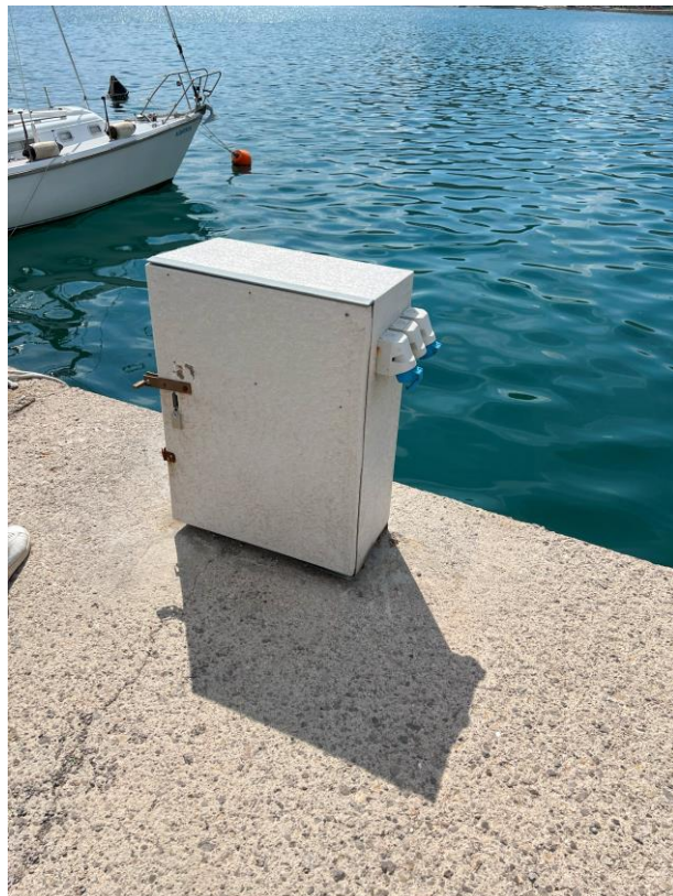
Εικόνα 5.10.2 Ερμάριο παροχής ηλεκτρικού ρεύματος και ύδρευσης
