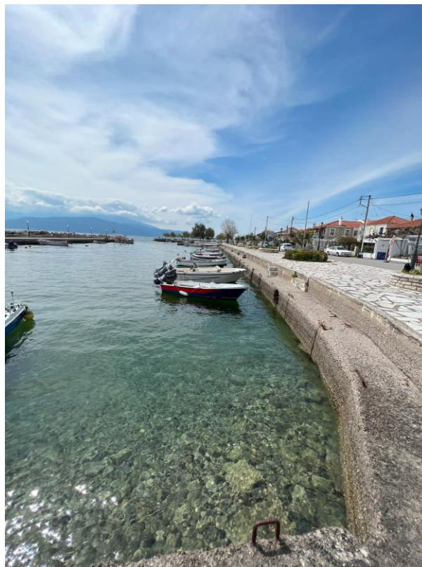
Εικόνα 5.24.7 Αδυναμία χρήσης θέσεων ελλιμενισμού λόγω ρηχού πυθμένα
