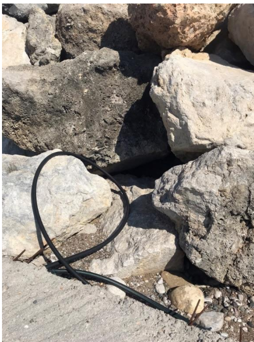
Εικόνα 5.1.8 Αναμονή ηλεκτρολογικής σύνδεσης
