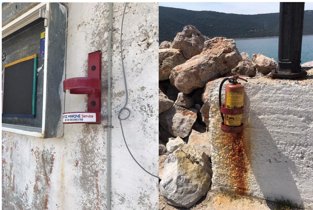
Εικόνα 5.2.14 Παρωχημένος πυροσβεστήρας και απουσία εξοπλισμού
