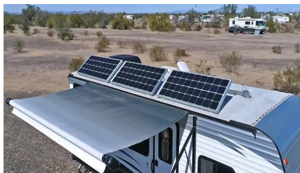
Εικόνα 4. Αυτόνομο φωτοβολταϊκό σύστημα
