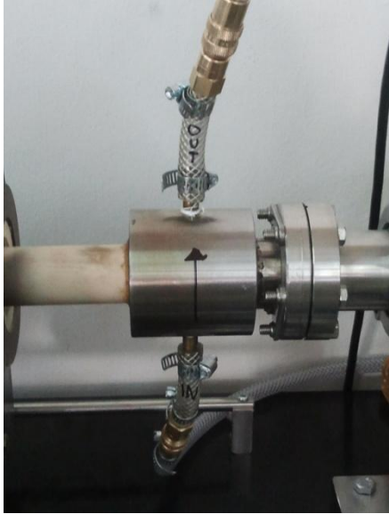
Σύνδεση των συνδέσεων νερού ψύξης του αντιδραστήρα με λάστιχα που καταλήγουν στον θερμοστάτη
