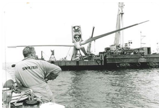
Εικόνα 1: Εικόνα 1: Πρώτο θαλάσσιο αιολικό πάρκο, Δανία 1991
