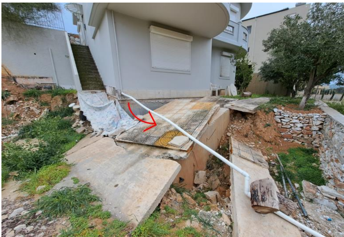
Εικόνα 1.12: Περιστροφή της τρίτης κατοικίας η οποία βρίσκεται στο αριστερό πλευρικό όριο της κατολίσθησης (η κίνηση υποδεικνύεται με το κόκκινο βελάκι)
