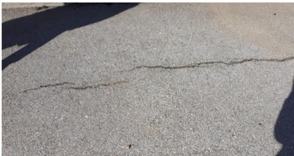
Εικόνα 1.14: Ρωγμές στο οδόστρωμα στην στέψη της κατολίσθησης
