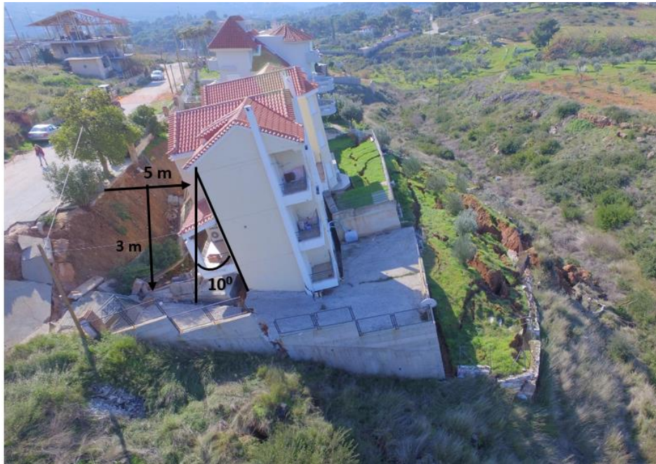
Εικόνα 1.7: Οι μετακινήσεις που υπέστησαν οι δυο κατοικίες που βρίσκονταν μέσα στην μάζα την κατολίθησης
