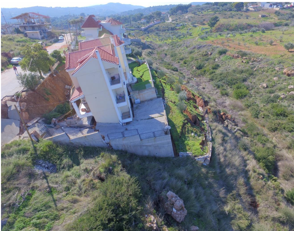
Εικόνα 1.3: Αποψη της κατολίσθησης από τον βορρά
