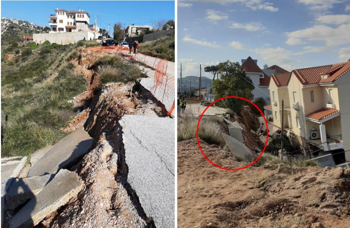
Εικόνα 1.13: Υποχώρηση οδοστρώματος στην περιοχή της κύριας κατακρήμνισης
