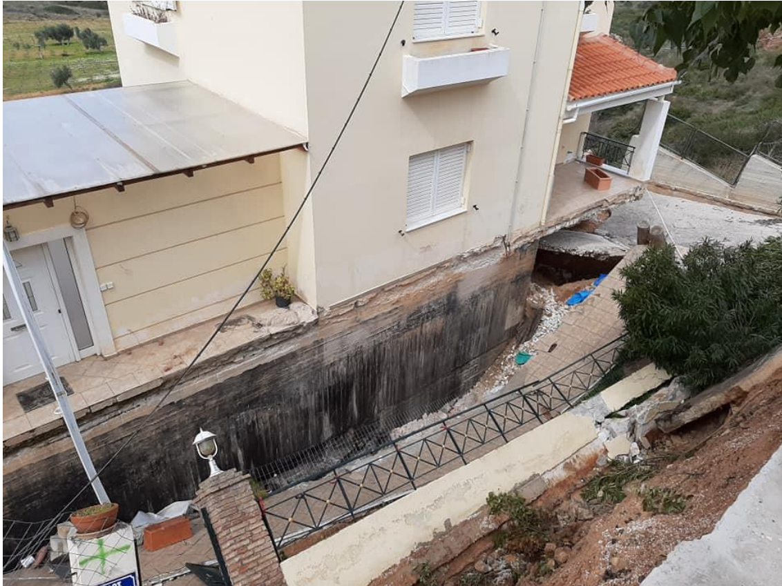
Εικόνα 4.21: Φωτογραφία από την στέγη της κατολίσθησης όπου φαίνεται η τοιχοποιία των δύο υπογείων του σπιτιού και γίνεται μέσω αυτού σαφές το γεγονός ότι η επιφάνεια αστοχίας είναι εφαπτομενική με το σημείο έναρξης της επιφάνειας θεμελίωσης προς την πλευρά της οδού
