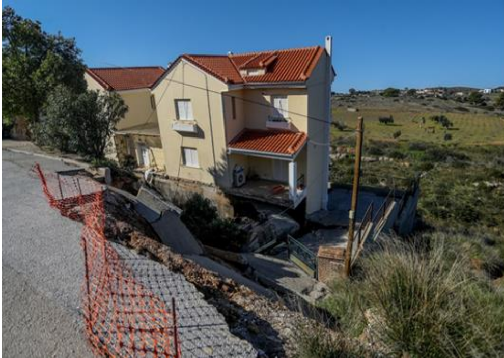
Εικόνα 1.2: Αποψη των ζημιών που υπέστη το οδόστρωμα στην οδό Καρυωτάκη λόγω της κατολίσθησης (φωτογραφία από την στέψη της κατολίσθησης)
