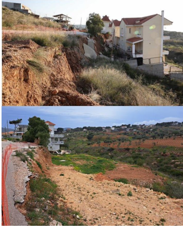
Εικόνα 1.9: Η περιοχή της αστοχίας πριν (πάνω) και μετά (κάτω) την κατεδάφιση των δυο κατοικιών.
