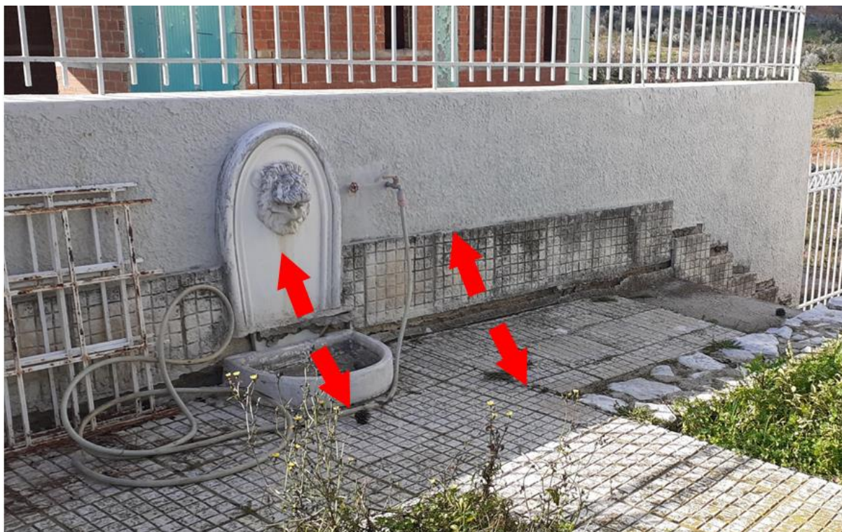
Εικόνα 1.11: Ζημιές στον πίσω αύλιο χώρο της τρίτης κατοικίας (με τα κόκκινα βελάκια φαίνεται η αποκόλληση των πλακακιών λόγω της περιστροφής του σπιτιού)
