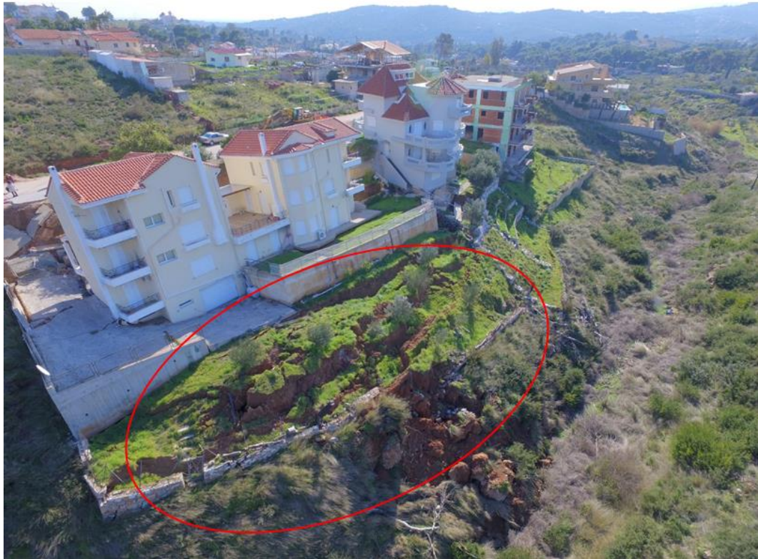
Εικόνα 4.13: Οι εγκάρσιες ρωγμές στην περιοχή συσσώρευσης των υλικών και ανύψωσής τους σε σχέση με την αρχική επιφάνεια του εδάφους
