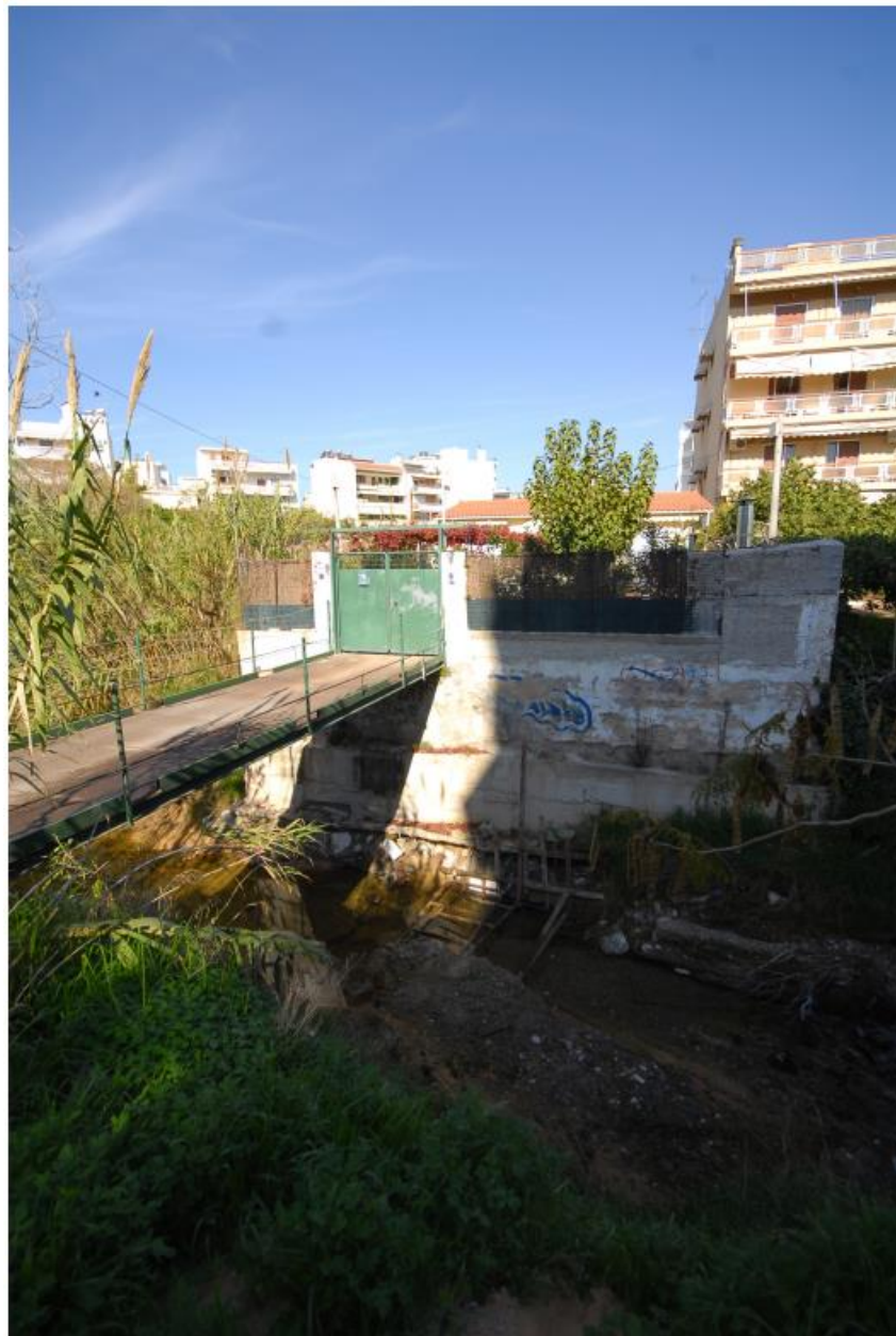
Φωτογραφία 21: Αυθαίρετο κτίσμα στο Βόρειο πρανές του ρέματος, με ιδιωτική εναέρια γέφυρα. Εμφανής διάβρωση διακρίνεται στη βάση του κτηρίου (ΜΠΕ Πικροδάφνης, 2021)
