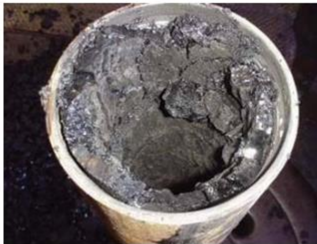
Εικόνα 4. Ασφαλτένια που φράζουν έναν σωλήνα [1].
