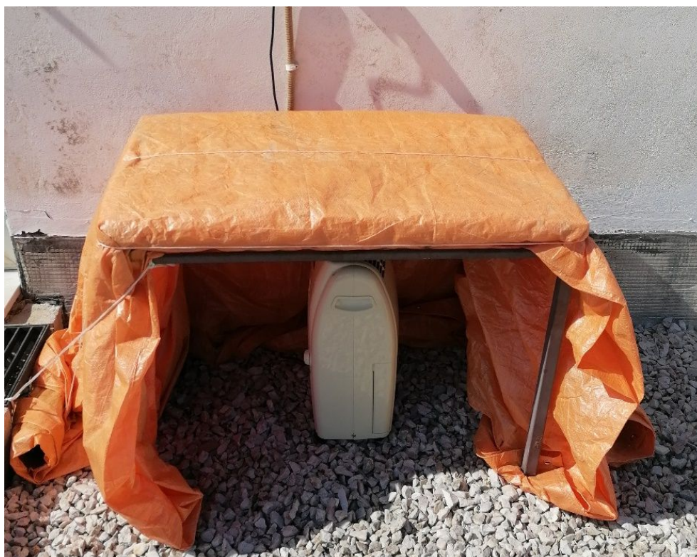
Σχήμα 5.9 : Αφυγραντήρας στην οροφή του Κτιρίου Κ για δειγματοληψία υγρασίας
