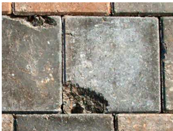
Εικόνα 3.8: Καταστροφή κυβόλιθου σκυροδέματος λόγω εφελκυστικής δύναμης (Block Paving - Choosing a Block or Brick Paver)
