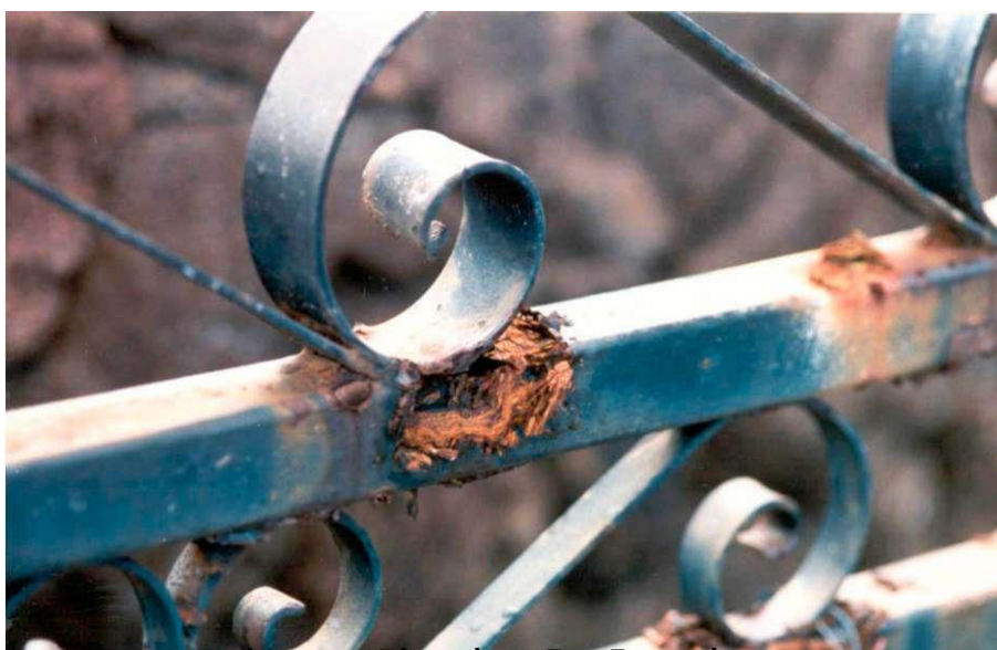
Διάβρωση λόγω ύπαρξης διεπιφάνειας
