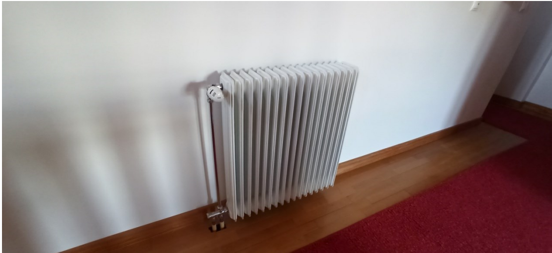
Εικόνα 4.24: Σώμα καλοριφέρ στο κτίριο ξενώνα
