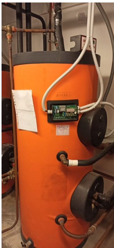
Εικόνα 4.25: Boiler ζεστού νερού χρήσης
