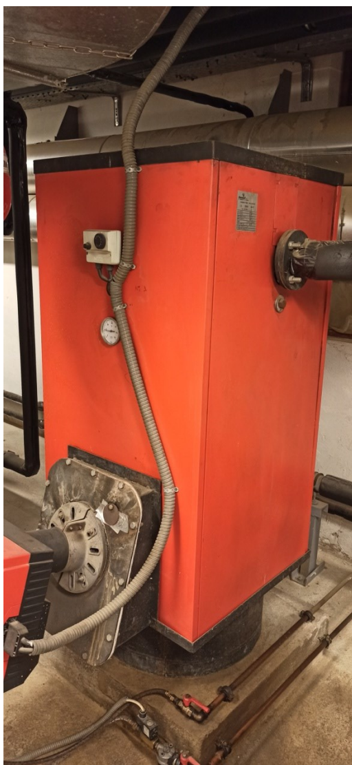
Εικόνα 4.21: Λέβητας πετρελαίου θέρμανσης
