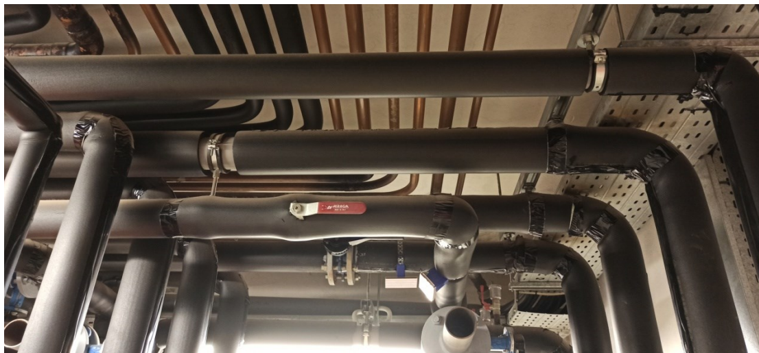
Εικόνα 4.27: Μόνωση σωληνώσεων μεταφοράς ζεστού νερού στο λεβητοστάσιο
