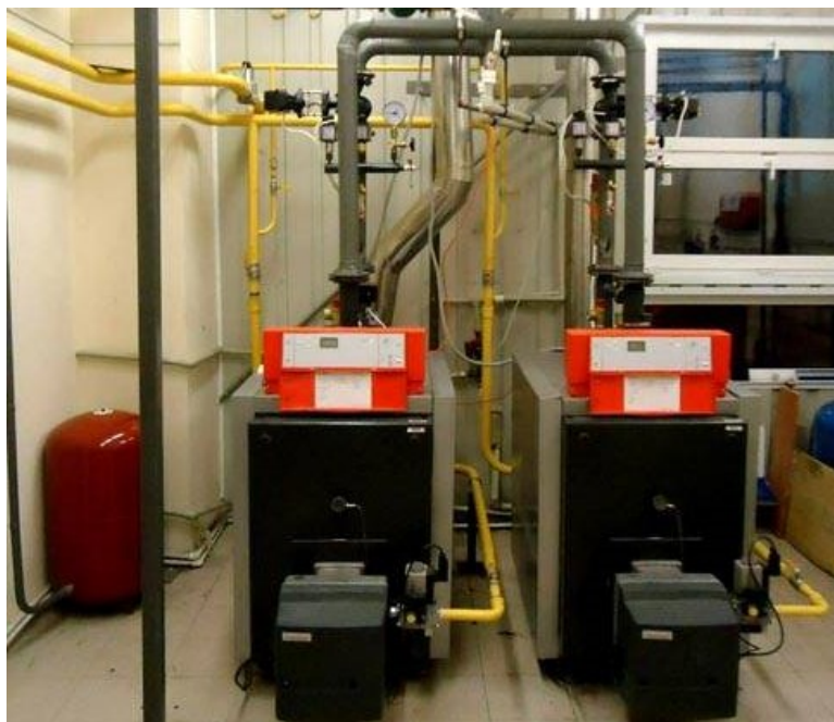
Εικόνα 4.42: Λέβητες φυσικού αερίου
