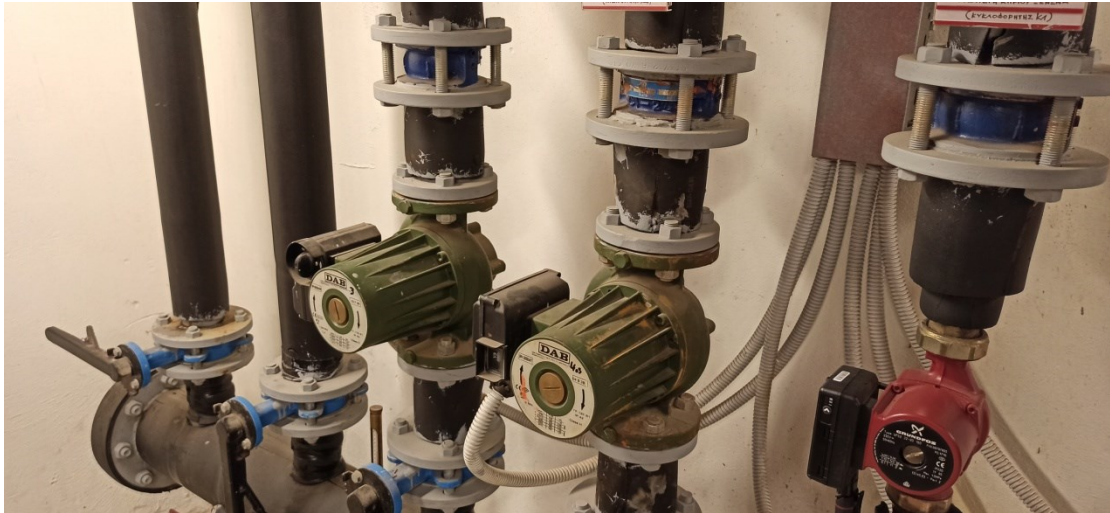
Εικόνα 4.22: Κυκλοφορητές νερού από λέβητες θέρμανσης
