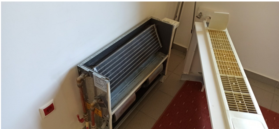
Εικόνα 4.23: Σώμα εξαναγκασμένης κυκλοφορίας αέρα (fan coil) στο κτίριο εργαστηρίων-σεμναρίων
