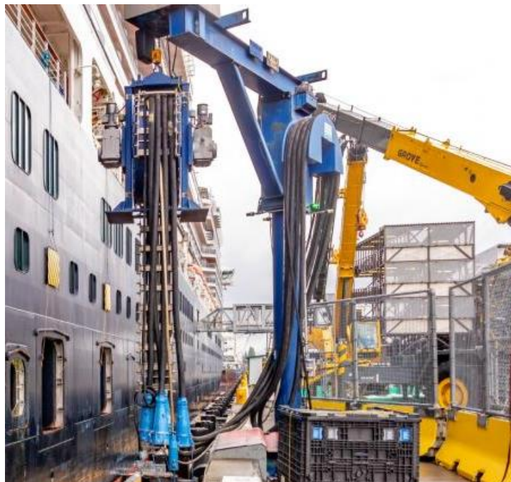
Σχήμα 13.13 : Καλώδια τροφοδοσίας από τη στεριά. Πηγή: Port of Seattle, https://www.portseattle.org/blog/past-present-and-future-shore-power
