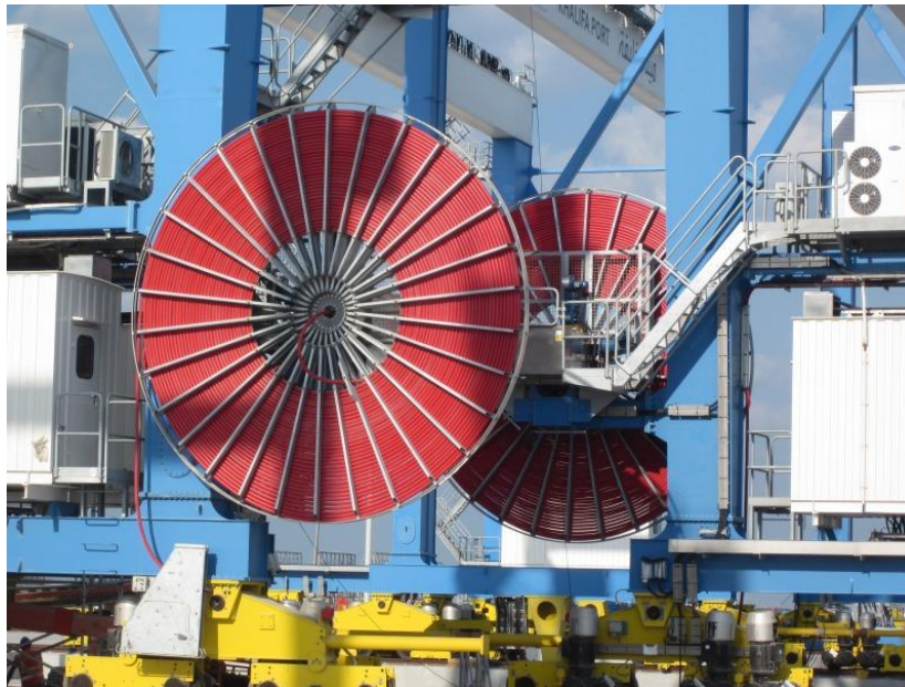
Σχήμα 16.16 : Σύστημα διαχείρισης καλωδίων. Πηγή: Cavotec, https://www.cavotec.com/en/your-applications/ports-maritime/crane-electrification/e-rtq/product-motorized-reels
