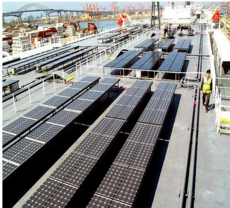
Εικόνα 20: Εγκατεστημένα φωτοβολταϊκά συστήματα σε πλοίο. [78]
