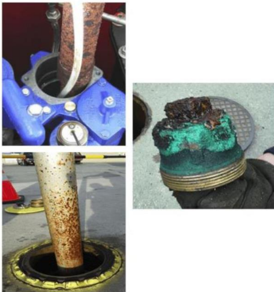
Εικόνα 1-10: Διάβρωση σε εξαρτήματα του συστήματος διακίνησης και αποθήκευσης [53].
