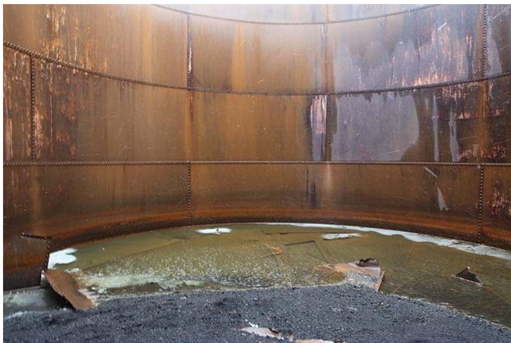
Εικόνα 1-12: Εσωτερικό δεξαμενής καυσίμου [66].
