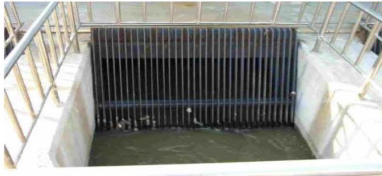
Εικόνα 6. Σχάρα εγκατεστημένη στην μονάδα επεξεργασίας αποβλήτων στην Μεταμόρφωση
