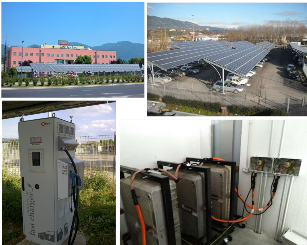
Σχήμα 10.6: Η υποδομή της πραγματικής περίπτωσης χρήσης στο Terni της Ιταλίας. Το εξεταζόμενο μικροδίκτυο αποτελείται από ένα τριώροφο κτίριο με γραφεία (πάνω αριστερά), δύο χώρους στάθμευσης με Φ/Β πάνελ (πάνω δεξιά), τρεις σταθμούς φόρτισης ηλεκτρικών οχημάτων (κάτω αριστερά) και ένα BESS (κάτω δεξιά).
