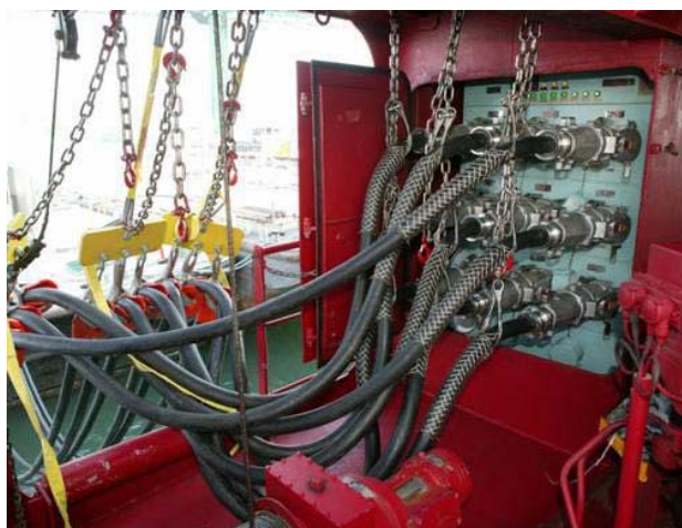
Εικ. 43. On-board cable connection [Πηγή: China Shipping]
