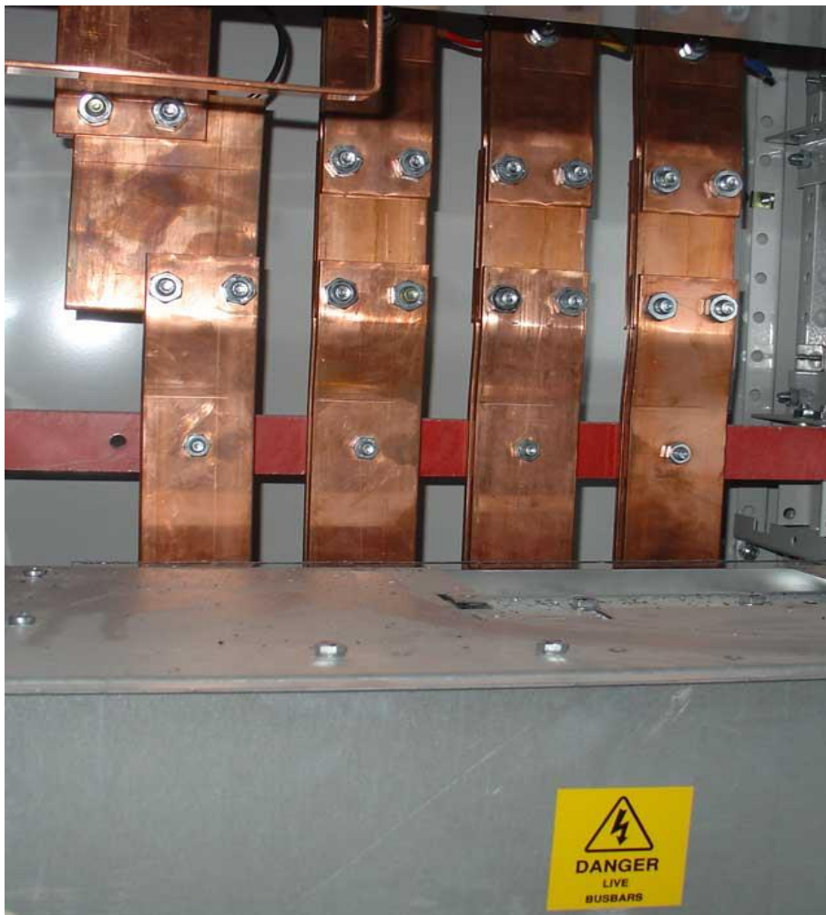
Εικόνα 28: Διάταξη χάλκινων ζυγών πίνακα για ένταση ρεύματος 1500A (Πηγή: Wikipedia)
