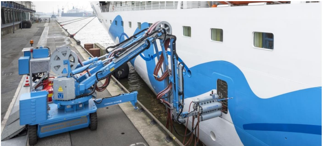
Εικόνα 11: Σύστημα τροφοδοσίας ρεύματος από τη στεριά (Πηγή: World Port Sustainability Program)
