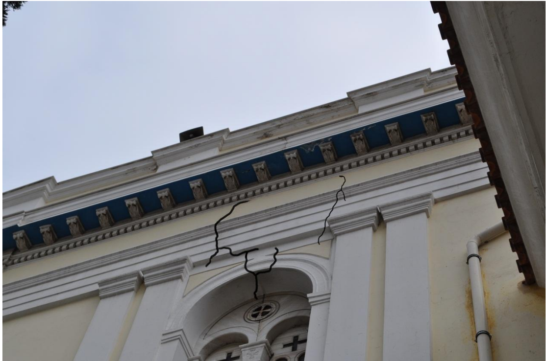
Εικόνα 4.9- Ρωγμή στη βόρεια όψη
