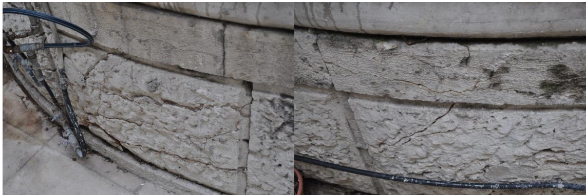
Εικόνα 2.12- Ρωγμές στη θεμελίωση του Ιερού Ναού
