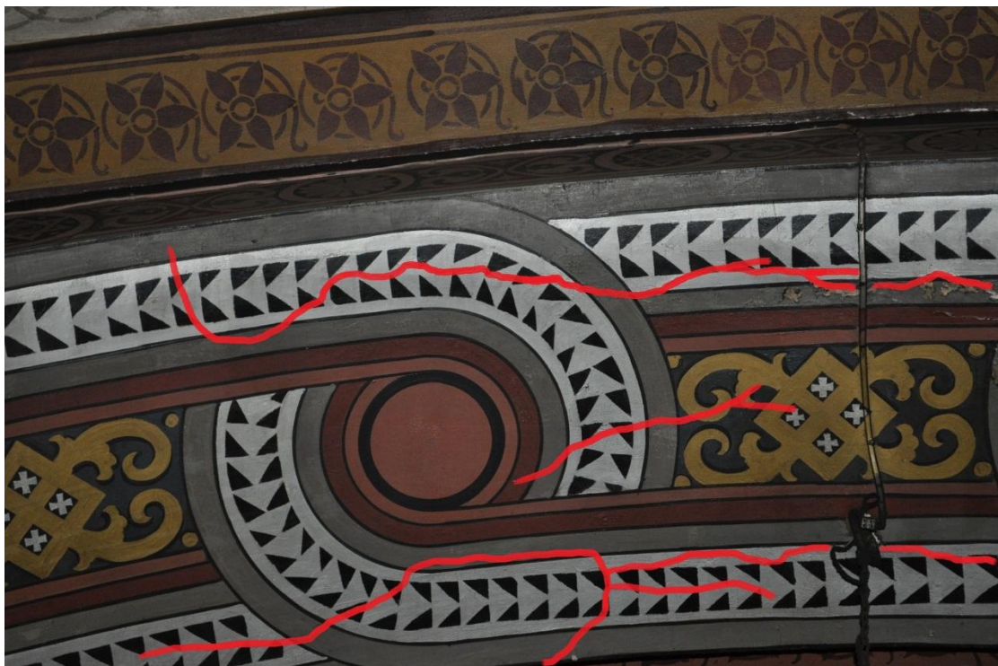
Εικόνα 4.6- Ρωγμές σε τόξο του γυναικωνίτη
