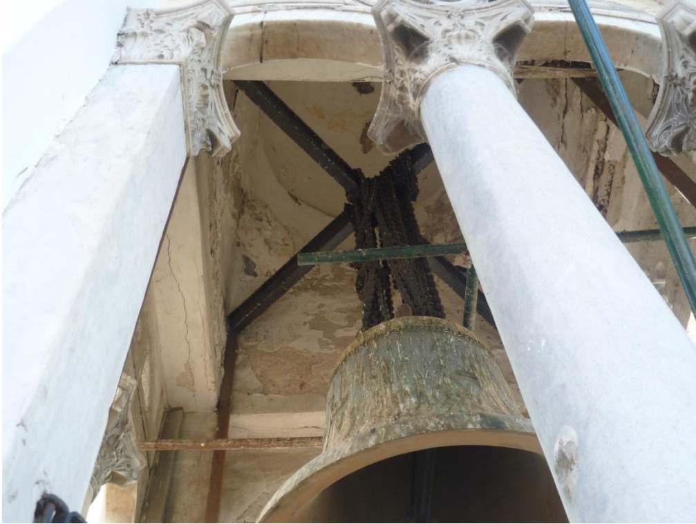
Εικόνα 4.17- Βλάβες εσωτερικά του κωδωνοστασίου
