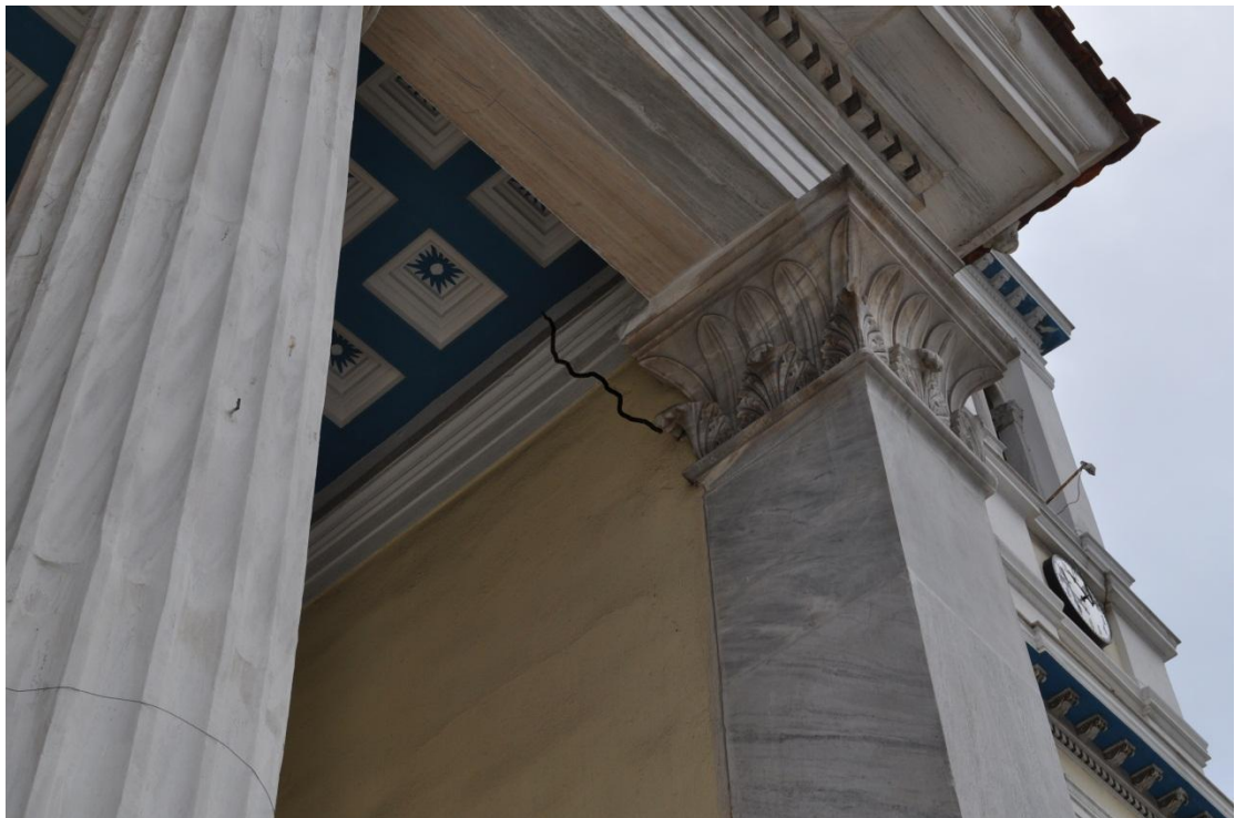
Εικόνα 4.10- Ρωγμή στη βόρεια όψη
