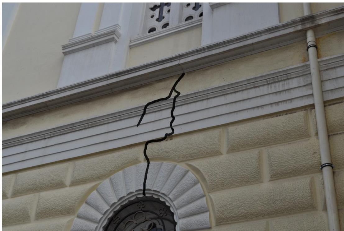
Εικόνα 4.8- Ρωγμή στη βόρεια όψη
