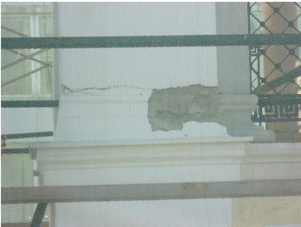
Εικόνα 4.16- Ρωγμή στη βάση του κωδωνοστασίου
