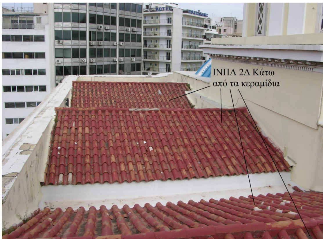
Εικόνα 7.2- Θέση ΙΝΠΑ 2Δ στην άνω παρειά της οροφής
