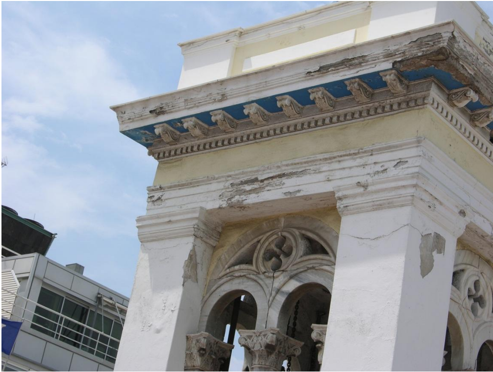
Εικόνα 4.15- Φθορές και ρηγματώσεις στο νότιο κωδωνοστάσιο
