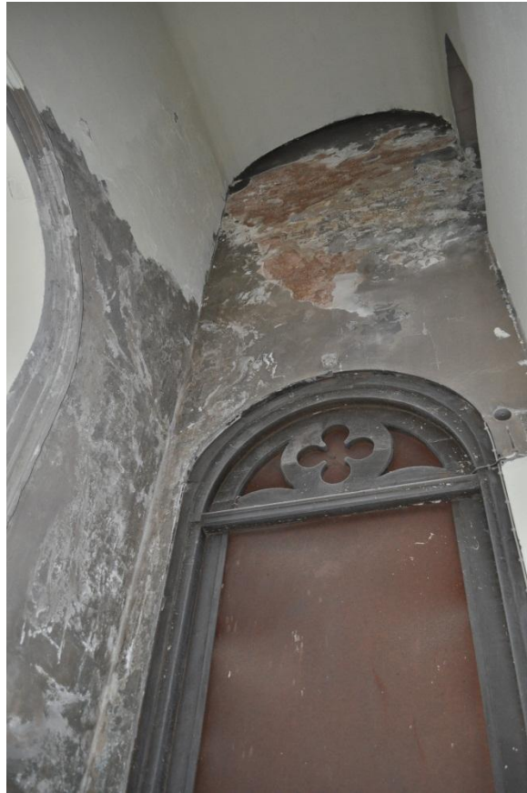
Εικόνα 4.18- Ρωγμές πάνω από την είσοδο της νότιας όψης
