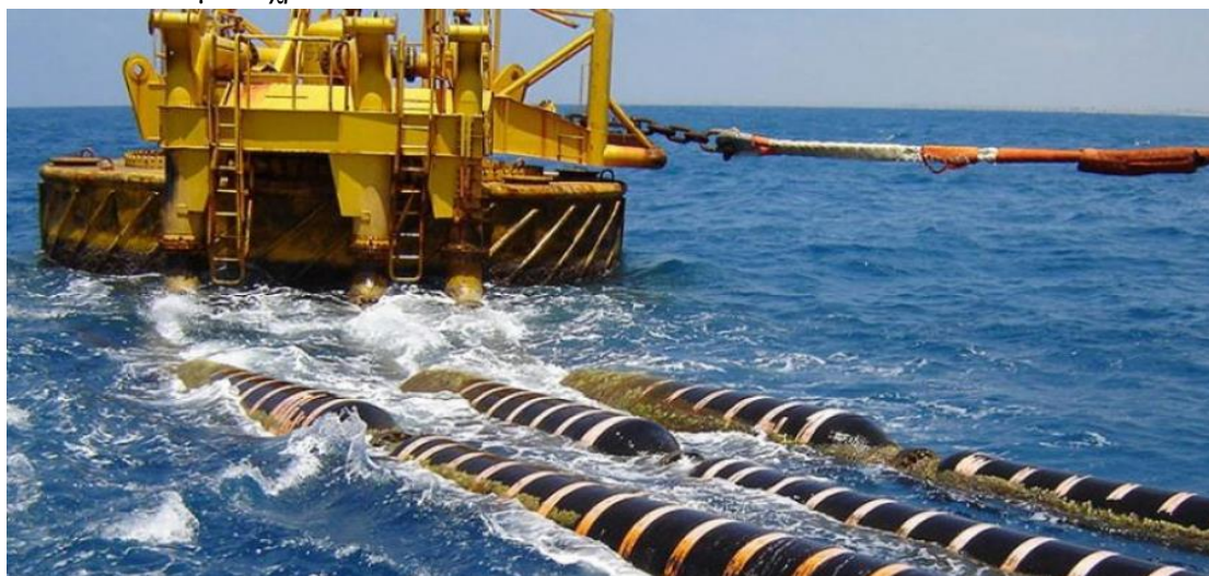
Εικόνα 1.3: Υπόγειες Γραμμές Μεταφοράς Ηλεκτρικής Ενέργειας [14].
