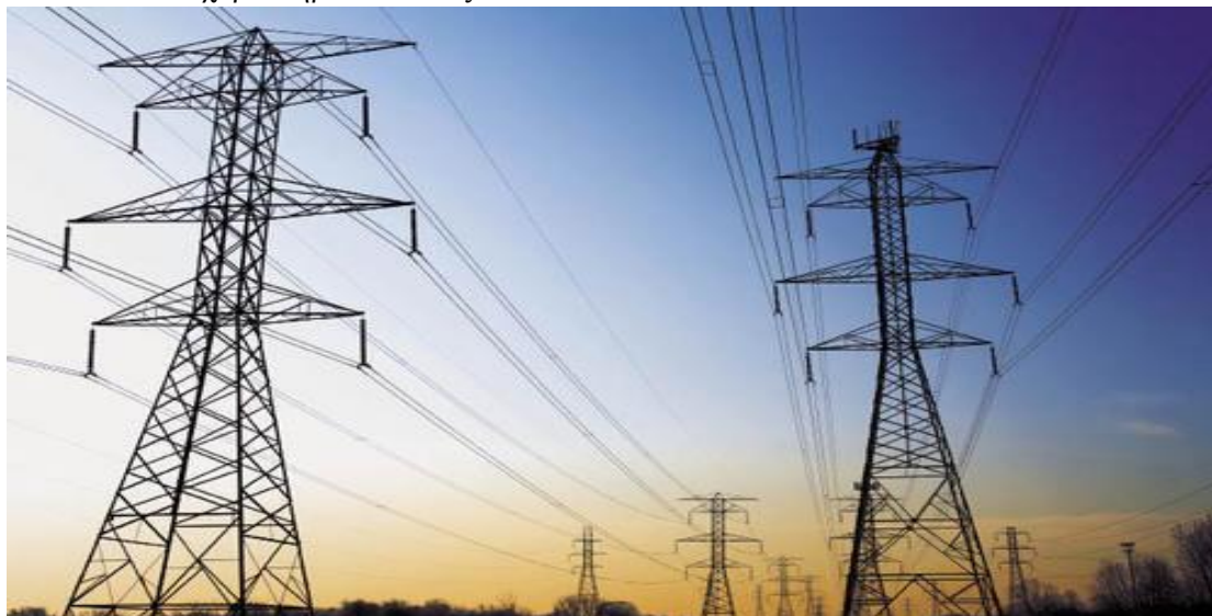
Εικόνα 1.2: Εναέριες Γραμμές Μεταφοράς Ηλεκτρικής Ενέργειας [13].
