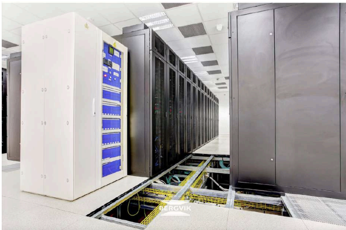
Εικόνα 17: Παράδειγμα χρήσης υπερυψωμένου ψευδοδαπέδου σε κέντρο δεδομένων. Πηγή: https://www.bergvik.com/products/floor/iso-floor-for-data-centres/
