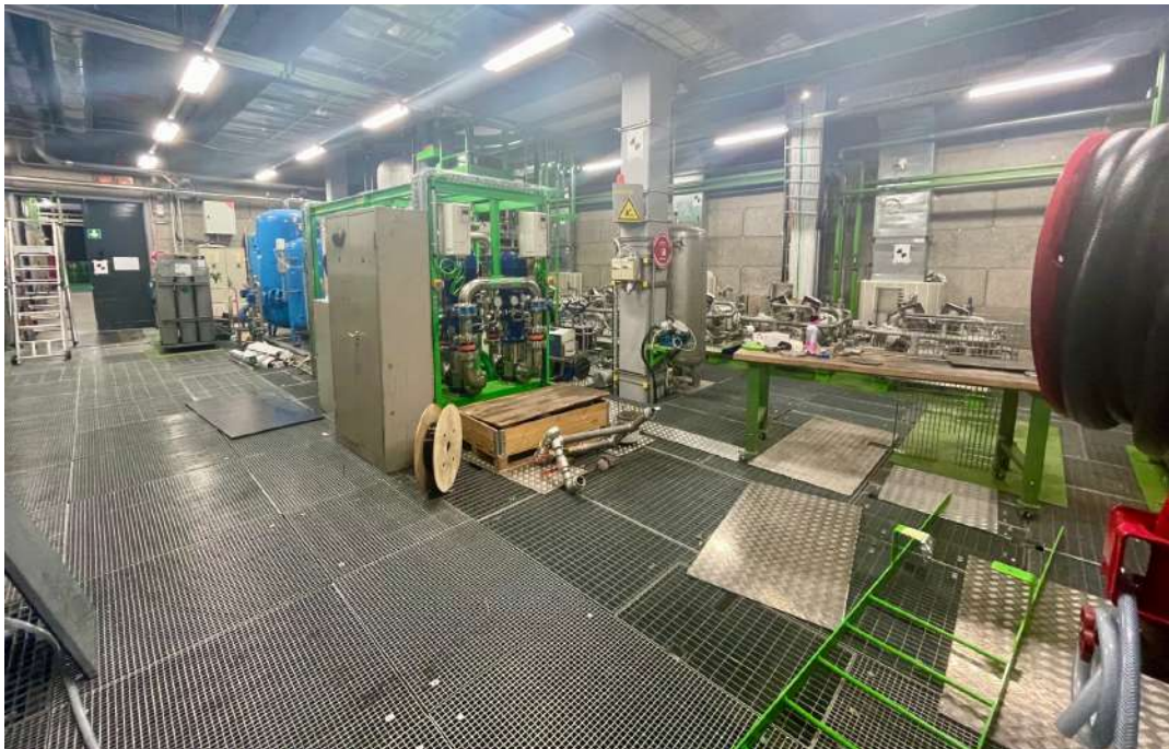
Εικόνα 54: Ευρυγώνια λήψη από το δωμάτιο ψύξης και εξαερισμού όπου διακρίνεται το τωρινό ψευδοδάπεδο (μεταλλικά καλύμματα – πάνελ). Πηγή: Συγγραφέας
