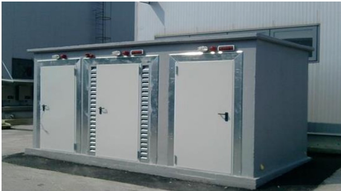
Εικόνα 3: Υποσταθμός μέσης τάσης βιομηχανικού τύπου
