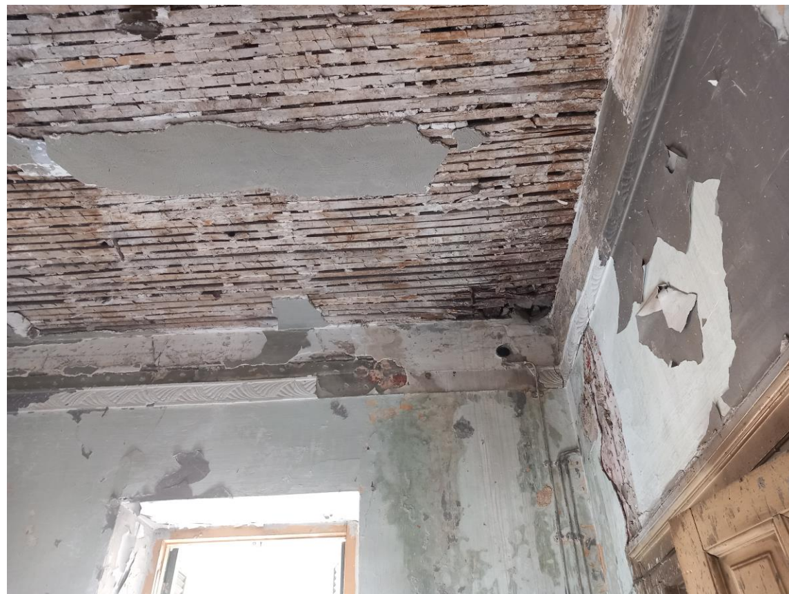
Εικόνα 1.11: Κατεστραμμένη οροφή ισόγειου με κατεστραμμένο γύψινο στοιχείο περιμετρικά.
