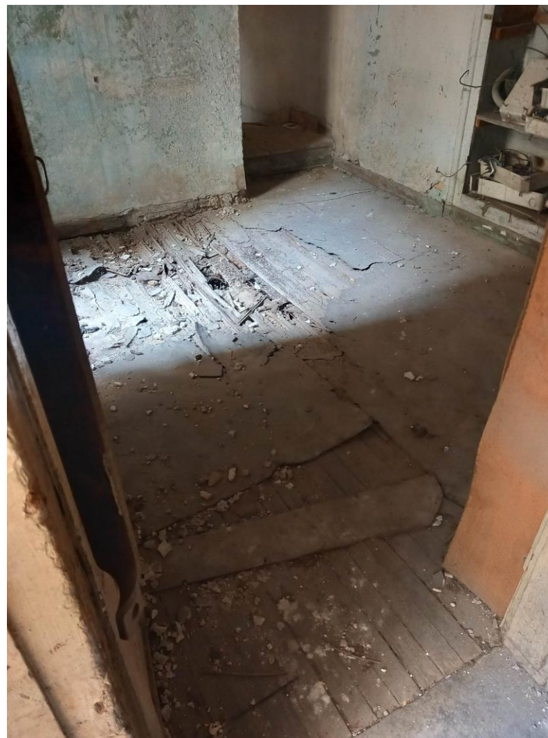
Εικόνα 1.13: Φθαρμένο ξύλινο πάτωμα ορόφου.
