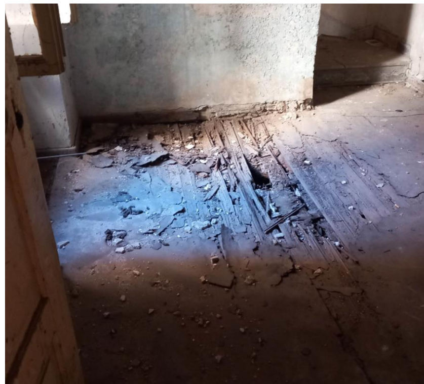
Εικόνα 2.16: Κατάσταση υφιστάμενου πατώματος στο ισόγειο του κτιρίου.
