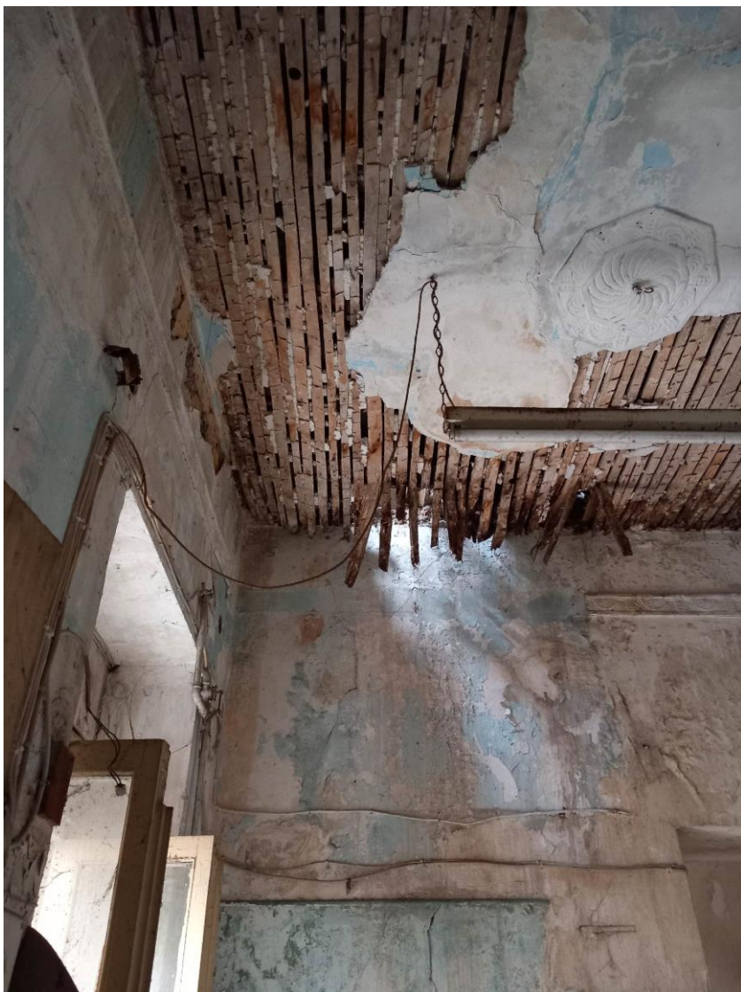
Εικόνα 1.14: Κατεστραμμένη ξύλινη οροφή ορόφου με ελάχιστες οροφολογίες και γύψινες λεπτομέρειες.
