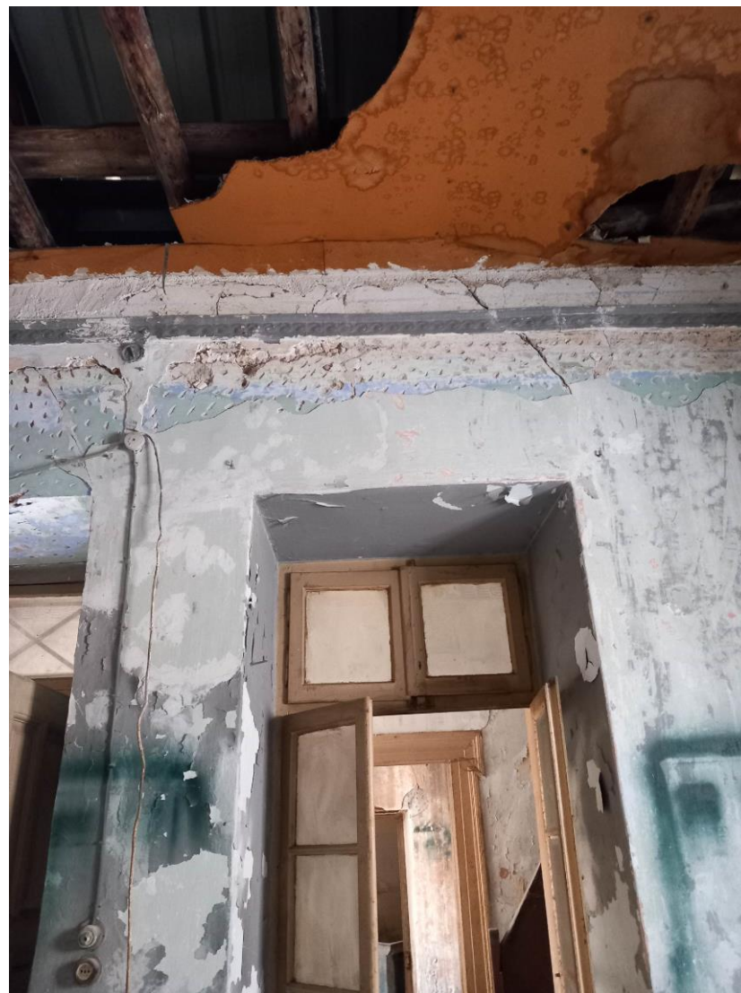
Εικόνα 1.15: Εσωτερικό ξύλινο κούφωμα με τζάμια στον όροφο και κατεστραμμένη στέγη.
