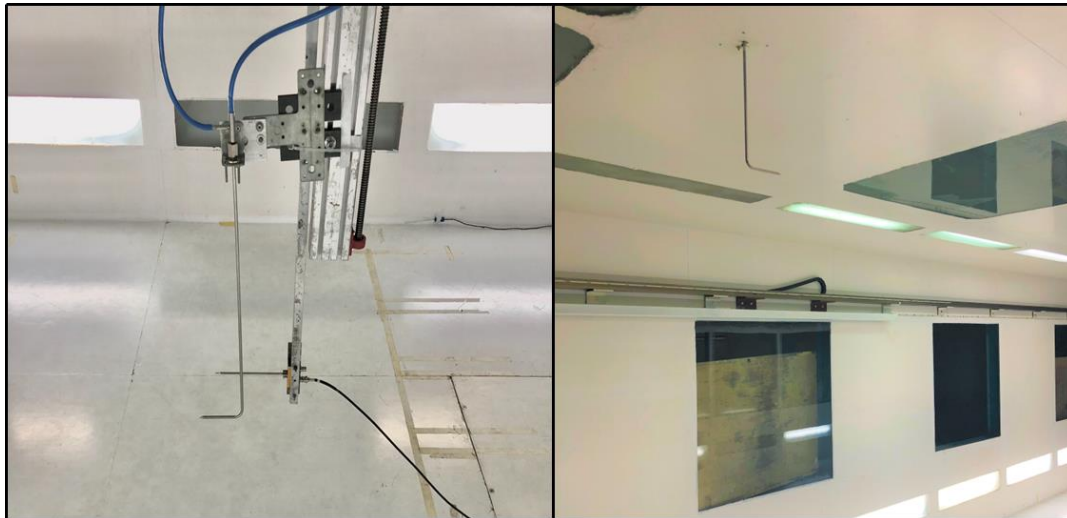
Σχήμα 2-14 – Σωλήνες Pitot εντός της εγκατάστασης.
