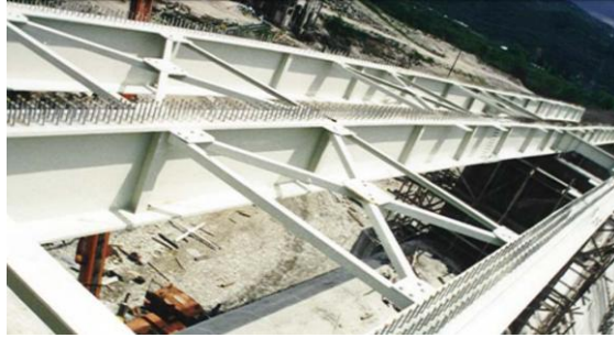
Figure 16.1: Παράδειγμα πλευρικής εξασφάλισης με χρήση οριζόντιων χιαστί συνδέσμων και ορθοστατών με διατομές τύπου L για την περίπτωση κυρίων δοκών (από [55])
