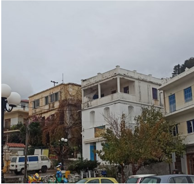
Εικόνα 9. Φθορές στα κτίρια λόγω υγρασίας και αλατότητας, σε κοντινή απόσταση από τη θάλασσα, Εύδηλος. Προσωπικό αρχείο.
