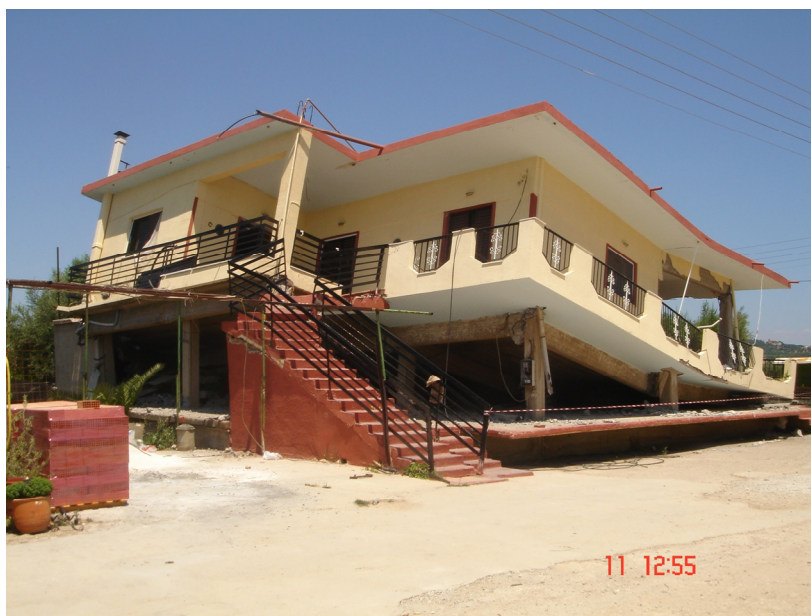
Εικόνα 4.1: Ζημιές σε κατασκευή με पुलωτή λόγω σεισμού (Σεισμός Ηλείας-Αχαΐας, Ιούνιος 2008)
