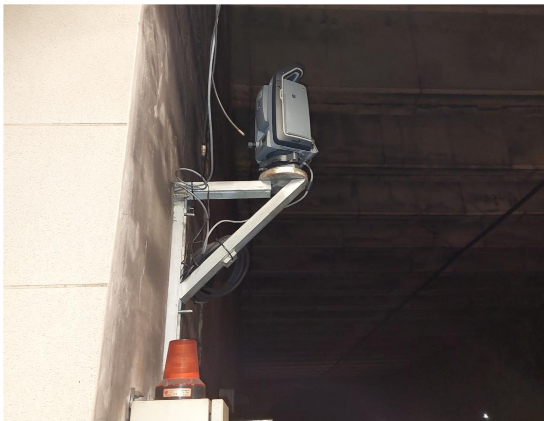
Εικόνα 2.3: Εξαναγκασμένη κέντρωση γεωδαιτικού σταθμού πάνω σε μεταλλική κατασκευή. (Σήραγγα μετρό Σταθμός Κατεχάκη).
