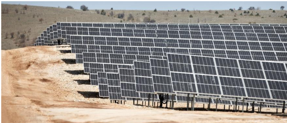
Σχ. 1-20: Επίγειο φωτοβολταϊκό Πάρκο [25] (ΕΛΠΕ Κοζάνη)
