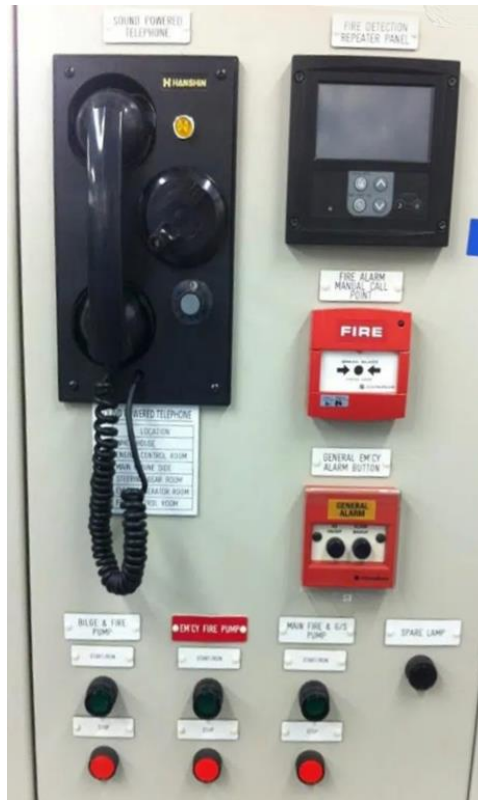
Εικόνα 13: Κεντρικός Πίνακας Ελέγχου Πυρανίχνευσης και Αναγγελίας Πυρκαγιάς
