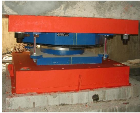
Εικόνα 3: 8 Εφέδρανο τύπου FPS της στέγης Ωνάση
