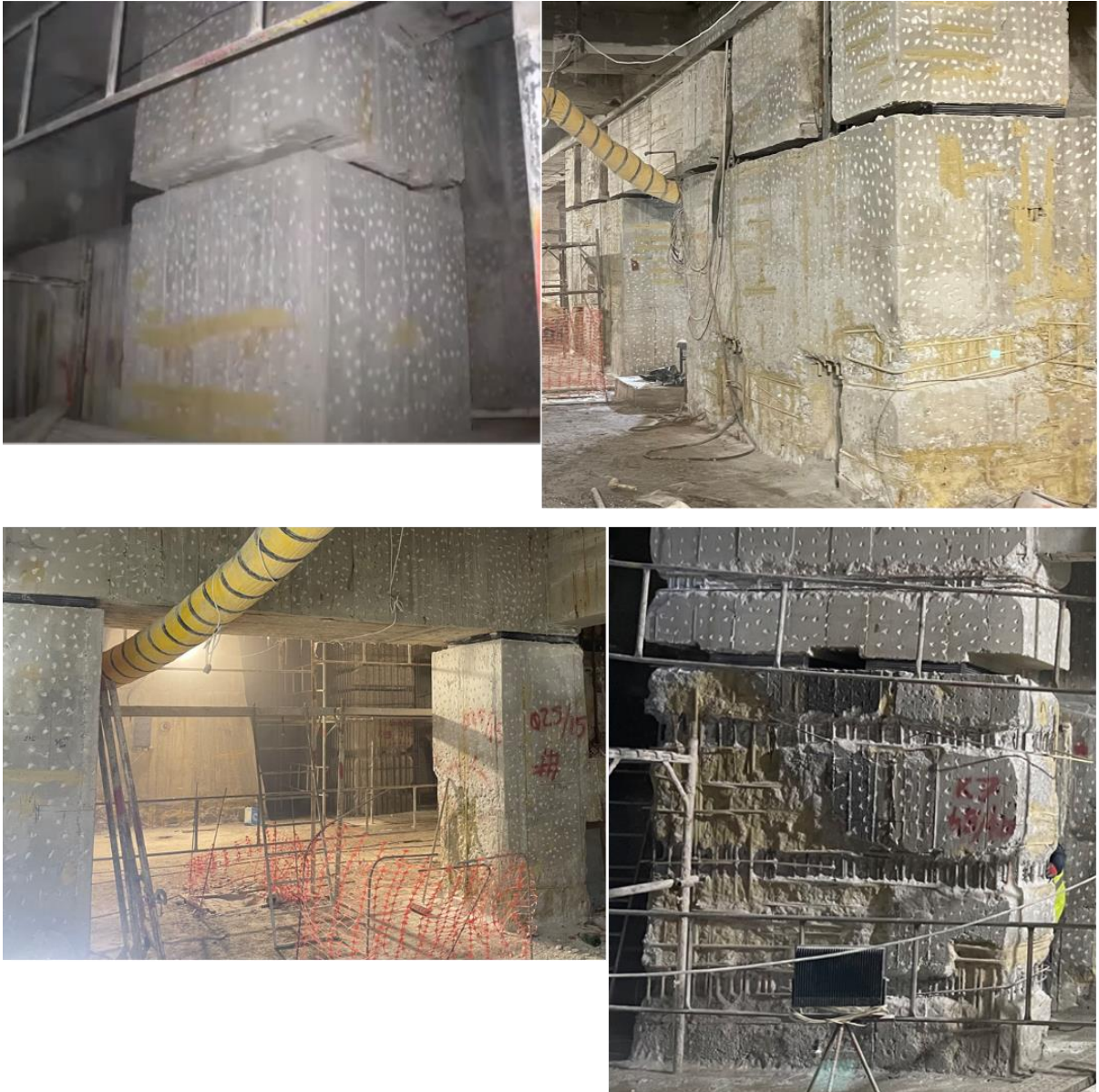
Σχήμα 1.3: Οι θέσεις των ελαστομεταλλικών εφεδράνων διακρίνονται στις εγκοπές των υποστυλωμάτων και τοιχίων πυρήνα στο Β' υπόγειο (από προσωπικό αρχείο)
