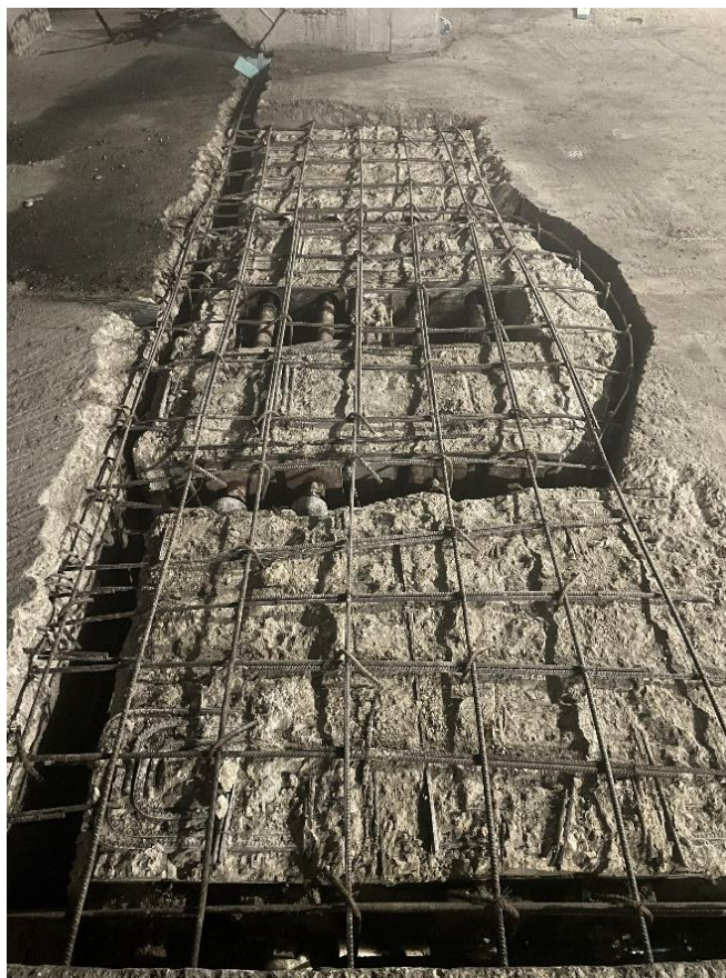
Σχήμα 5.7: Αντισεισμικός αρμός περίπου 10 εκατοστά. Κίνδυνος κρούσης. Οι οπλισμοί έχουν τοποθετηθεί στο στάδιο της ενίσχυσης, λόγω πάκτωσης της βάσης. (από προσωπικό αρχείο)
