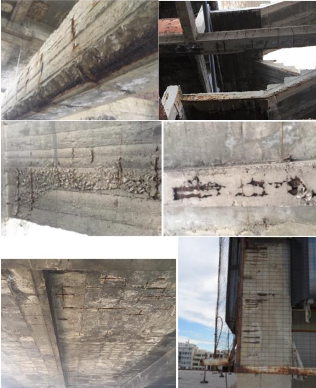
Σχήμα 2.1: Κακοτεχνίες/κατασκευαστικές αστοχίες/κακή συντήρηση Φ.Ο. Παρατηρείται απόμιξη, διάβρωση οπλισμών, ελλιπής επικάλυψη οπλισμού και απόθεση αλάτων (από Πύργος Πειραιά- Διερεύνηση Μηχανικών Χαρακτηριστικών των Υφιστάμενων Υλικών [21])
