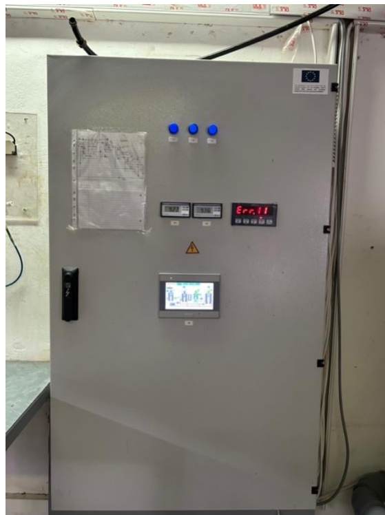
Εικόνα 32: Πίνακας Ελέγχου PLC
