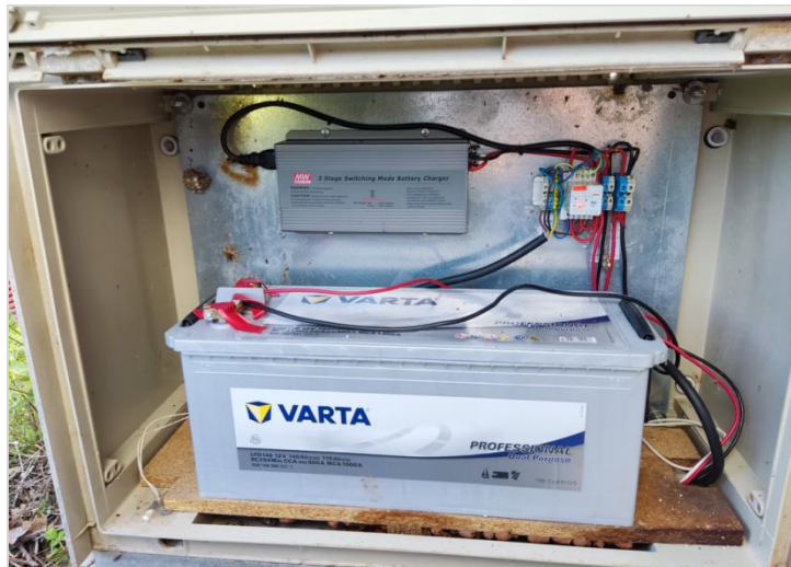
Εικόνα 2.8 Σύστημα εφεδρείας συναγερμού
