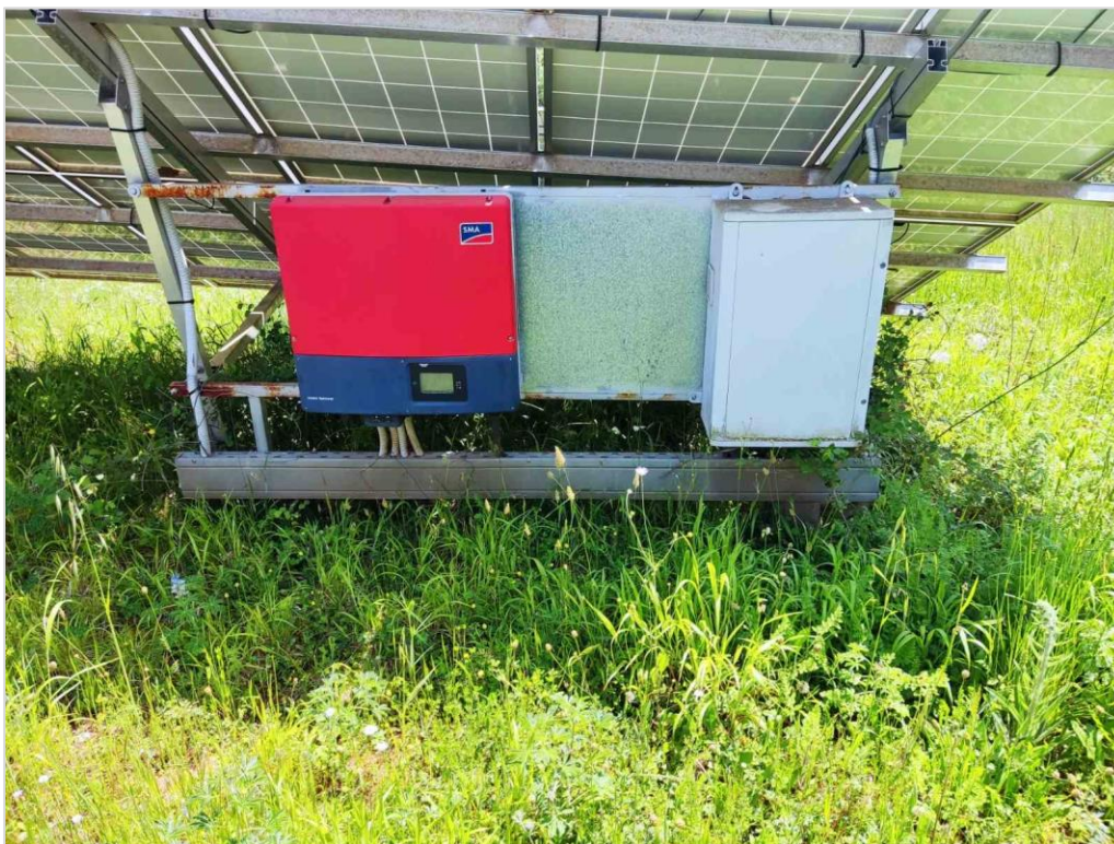
Εικόνα 2.6 Φωτογραφία αντιστροφέα και πίνακα ομαδοποίησης εγκατεστημένου στο έργο (2023)
