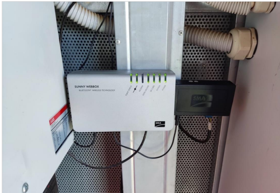
Εικόνα 2.11 Φωτογραφία του εγκατεστημένου στο έργο Sunny WebBox μέσα στον οικίσκο του Υ/Σ
