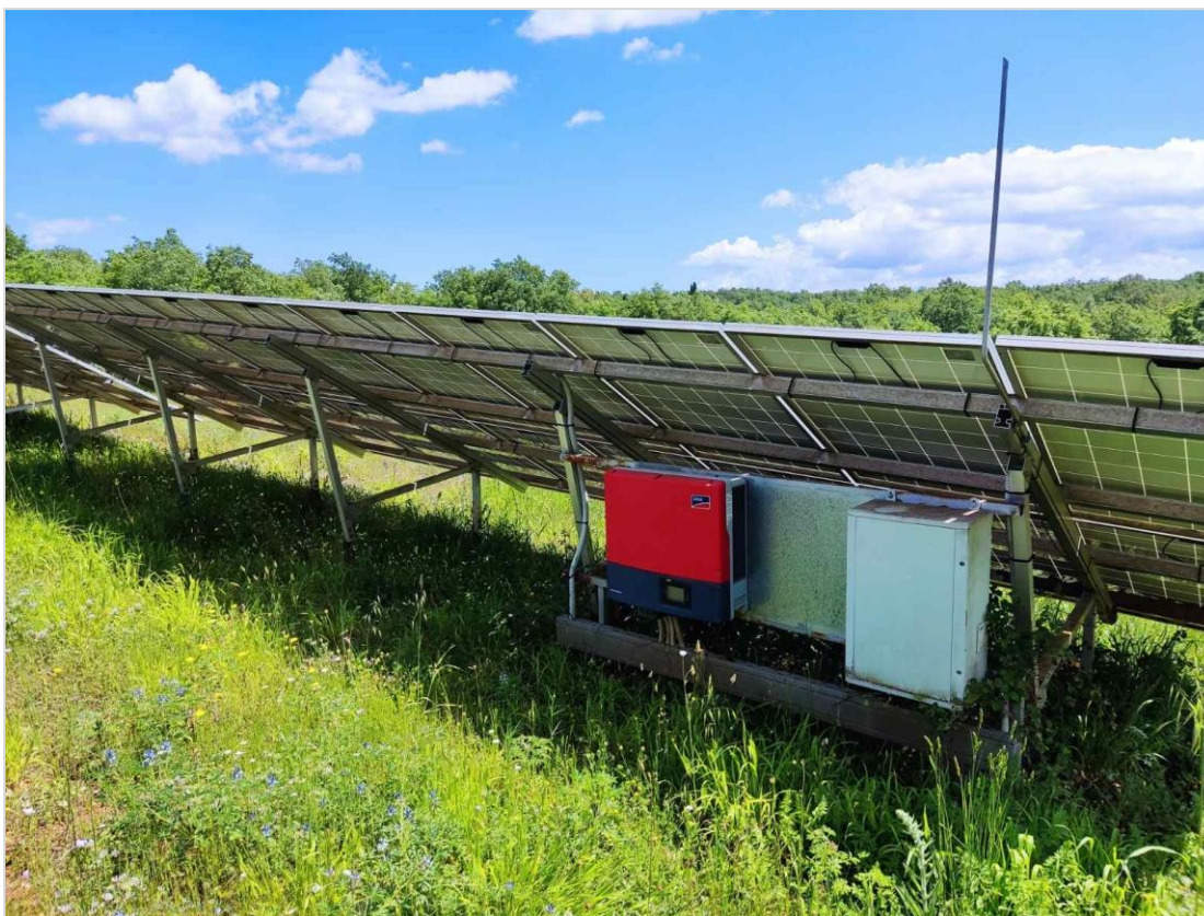
Εικόνα 2.2 Φωτογραφία μιας συστοιχίας της εγκατάστασης (2023)
