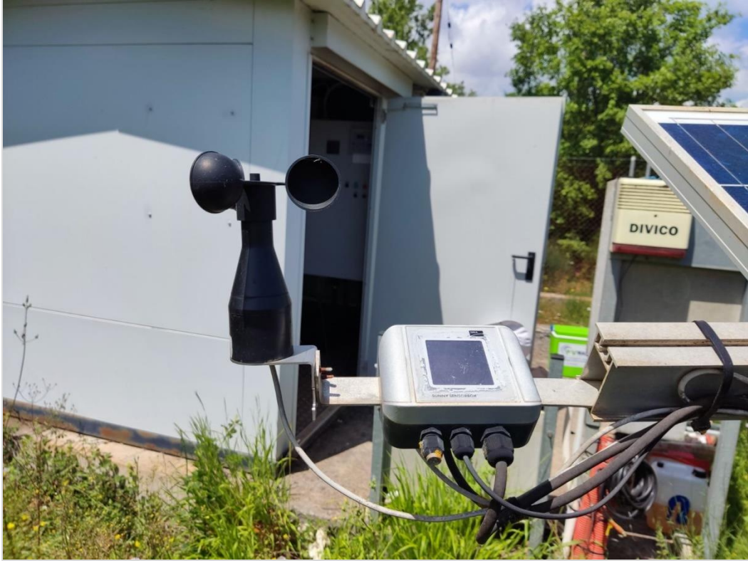
Εικόνα 2.10 Φωτογραφία του εγκατεστημένου στο έργο μετεωρολογικού σταθμού με το ανεμόμετρο, το πυρανόμετρο και το θερμόμετρο για τη μέτρηση της θερμοκρασίας περιβάλλοντος
