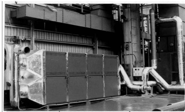
ΣΧΗΜΑ 7.4: Βιομηχανική μονάδα αποθήκευσης θερμότητας βάσει ΥΑΦ. Σε πρώτο πλάνο, ο εναλλάκτης του συστήματος με τις κυψέλες τοποθέτησης ΥΑΦ
