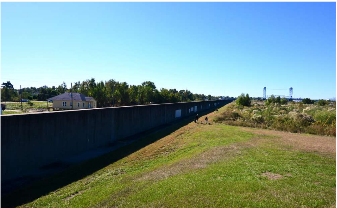
Εικόνα 27: Το φράγμα, στο σημείο που είχε καταρρεύσει στο Κατώτατο Ένατο Διαμέρισμα, σήμερα. Πλέον, στις πλατφόρμες βραχυχρόνιας μίσθωσης παρουσιάζεται ως “ιδανικό μέρος” για άθληση και βόλτα με τα κατοικίδια (προσωπικό αρχείο).
