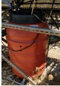
Εικόνα 68: Δεξαμενή προθέρμανσης της εισόδου SW στο MSS
