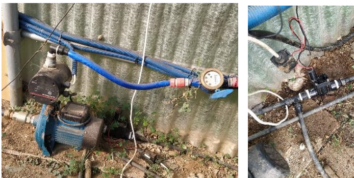
Εικόνα 58: Το πιεστικό μηχάνημα άρδευσης με το ενσωματωμένο ροόμετρο στο PGH (αριστερά) και Εγκατεστημένη ηλεκτροβάνη άρδευσης πεδίου του PGH (δεξιά)
