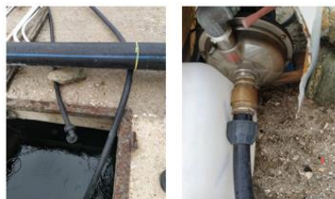
Εικόνα 35: Άντληση θαλασσινού νερού στο HYDRO5
