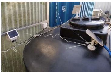
Εικόνα 47: Χαμηλού κόστους Φ/Β για την τροφοδοσία των αισθητήρων στη δεξαμενή άρδευσης
