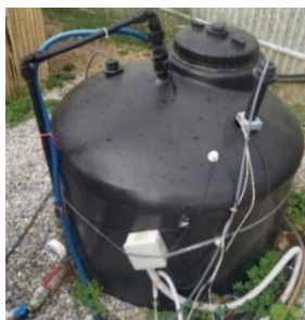
Εικόνα 42: Κεντρική δεξαμενή του παραγώμενου γλυκού νερού στο HYDRO5
