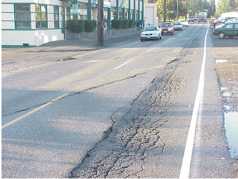
Εικόνα 4.9: Επιφανειακή φθορά λόγω παραμένουσας παραμόρφωσης στρώσης έδρασης Πηγή: (Pavement Interactive, 2023)
