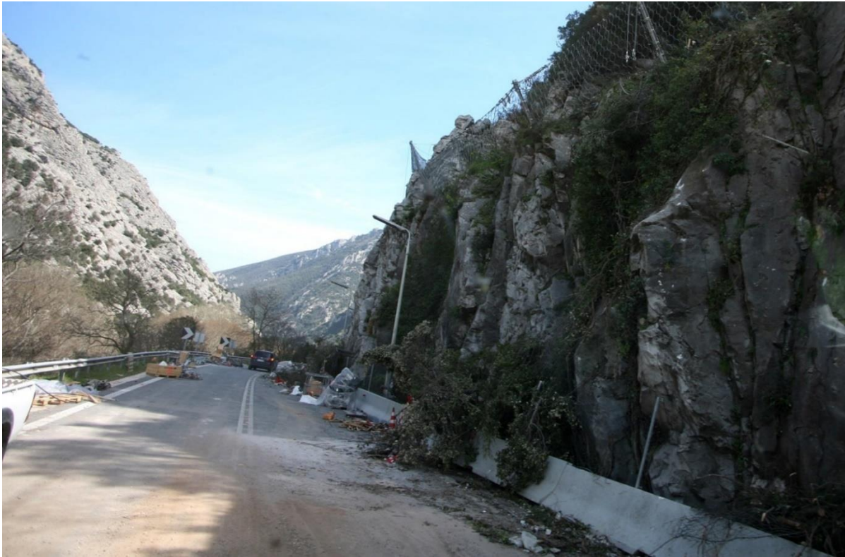
Εικόνα 2.12 Αποτελέσματα κατολίσθησης στα Τέμπη(16/10/2010) ΠΗΓΗ https://www.newsit.gr/wp-content/uploads/2017n/07/1490221.jpg
