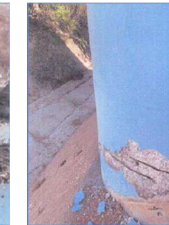
Φ.8 Αποκόλληση σκυροδέματος και εμφάνιση οξείδωμένων οπλισμών
