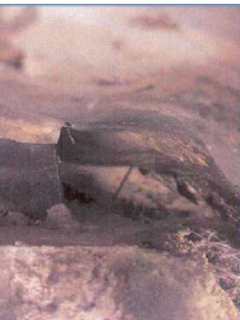
Φ.6 Αποκόλληση τεμαχίου σκυροδέματος στη βάση του στόλου
