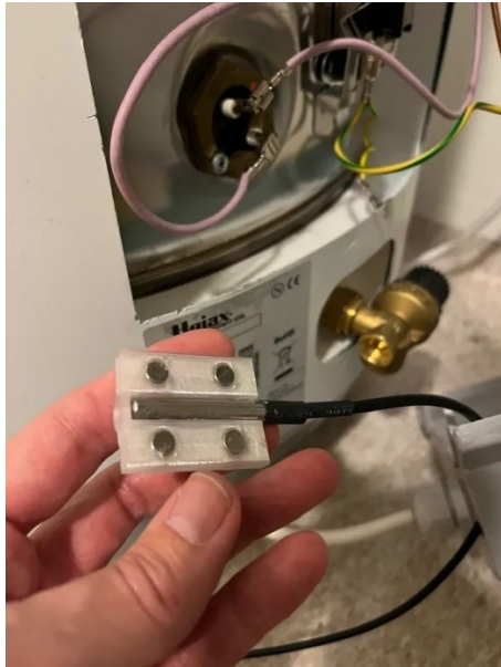
Εικόνα 10. Τοποθέτηση αισθητήρα θερμοκρασίας και υγρασίας στον θερμοσίφωνα
