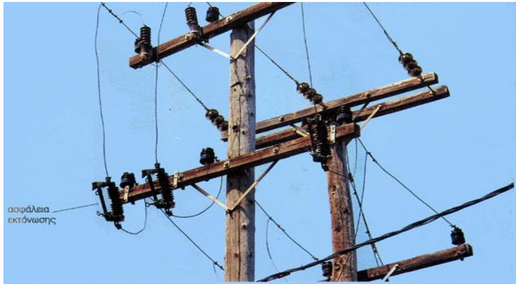
Εικόνα 21 Ασφαλειοαποζεύκτες μέσης τάσης. [19]
