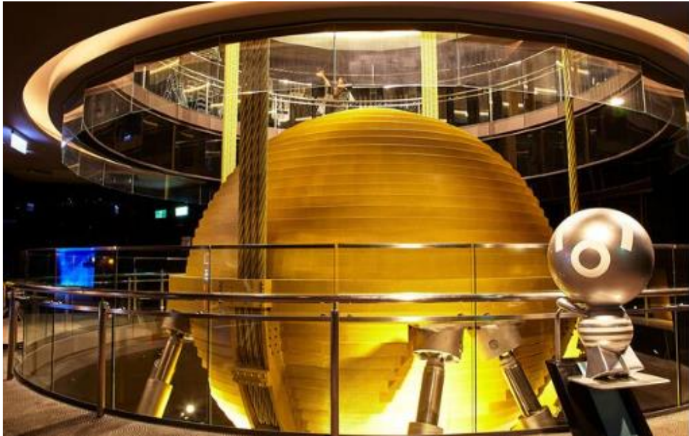
Εικόνα 25: Αποσβεστήρας συντονιζόμενης μάζας στον ουρανοξύστη «Ταίρει 101» (πλάγια όψη)
