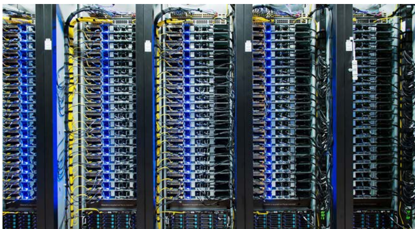
1.2 Στοιχισμένα racks (το καθένα έχει 20 servers) σε Data Center της Facebook.
