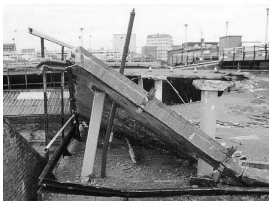
Εικόνα 1.3: Πραγματική αστοχία έναντι διάτρησης σε οροφή χώρου στάθμευσης, πηγή: (ASCE Library, 2010)
