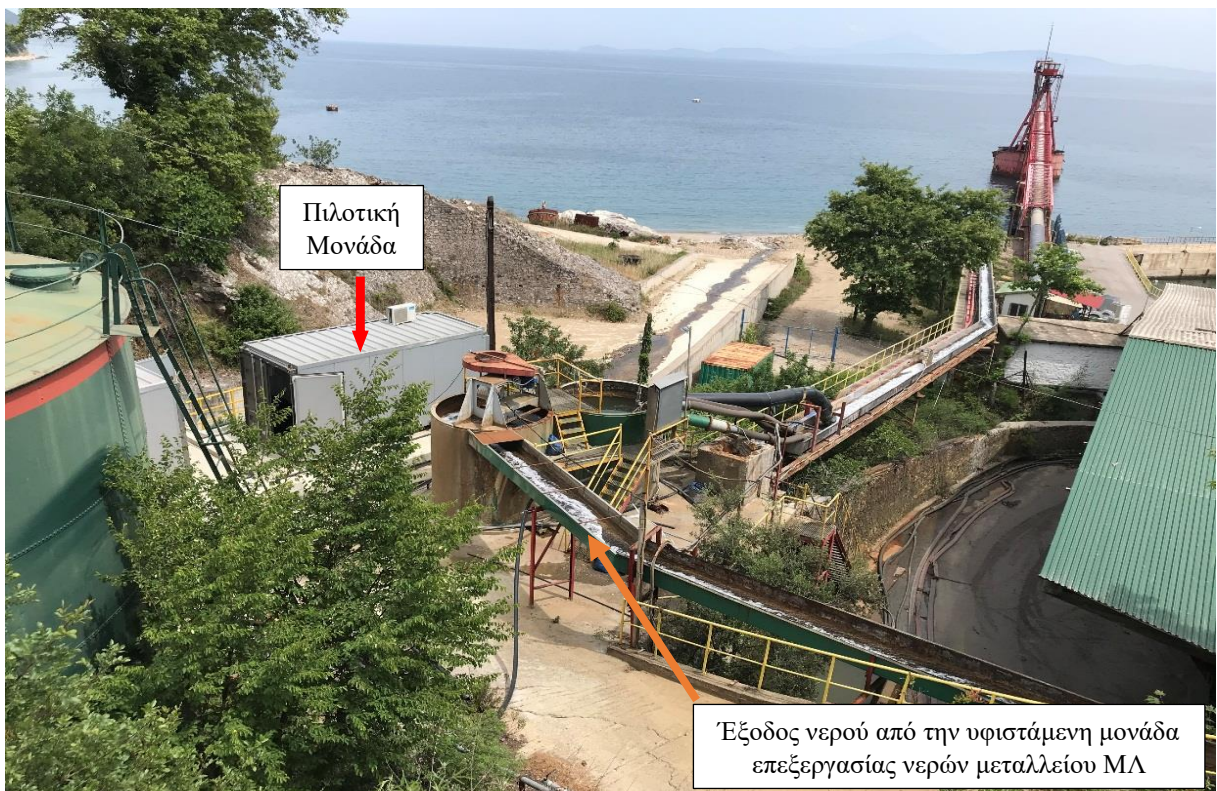
Φωτογραφία 6-7: Κοντινή άποψη του χώρου εγκατάστασης της πιλοτικής μονάδας για την πρόσθετη κατεργασία των νερών μεταλλείου Μαντέμ Λάκκου
