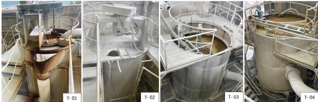
Φωτογραφία 5-1: Δεξαμενές κατεργασίας νερών μεταλλείου Ολυμπιάδας
