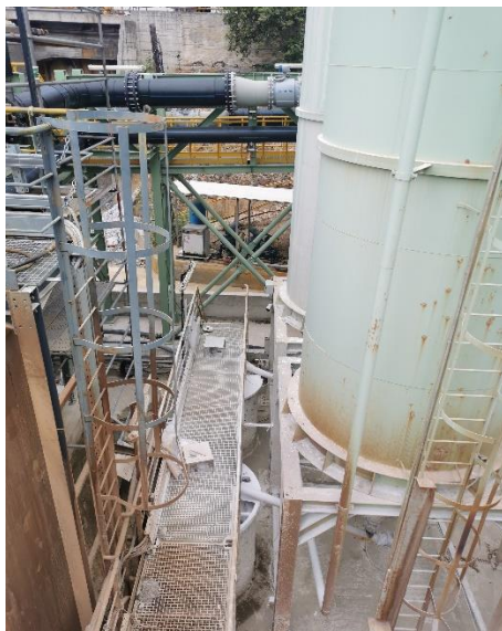
Σιλό αποθήκευσης υδρασβέστου και μεταλλικές δεξαμενές παρασκευής πολφού υδρασβέστου
