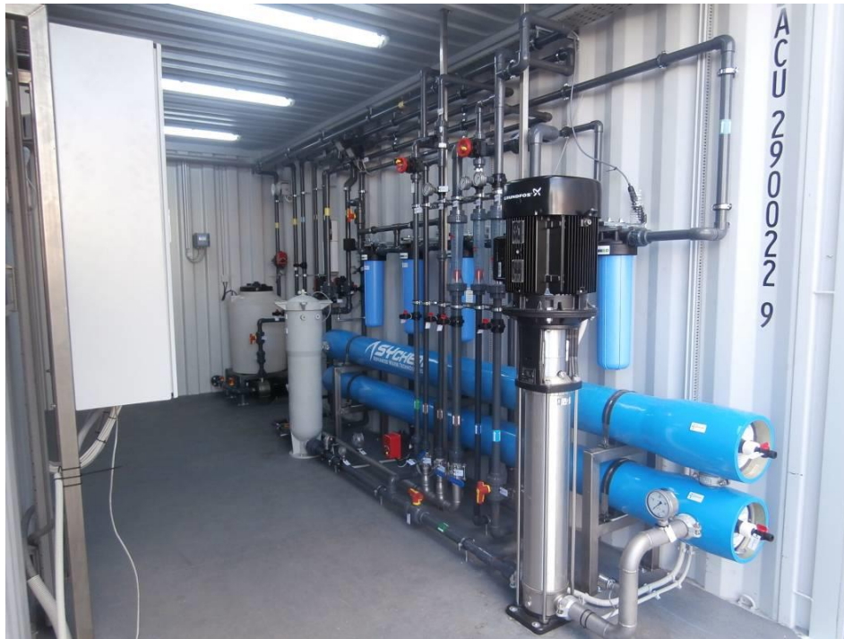
Φωτογραφία 6-8: Πιλοτική μονάδα για την πρόσθετη κατεργασία των νερών μεταλλείου - Απεικόνιση του σταδίου της Αντίστροφης Ωσμωσης
