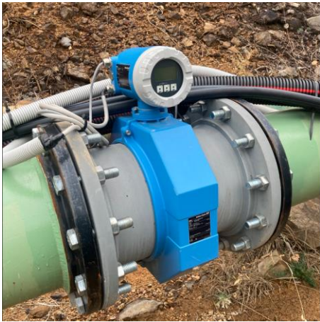
Ηλεκτρομαγνητικό παροχόμετρο μέτρησης παροχής νερού στην είσοδο της μονάδας επεξεργασίας νερών μεταλλείου (KROHNE)
