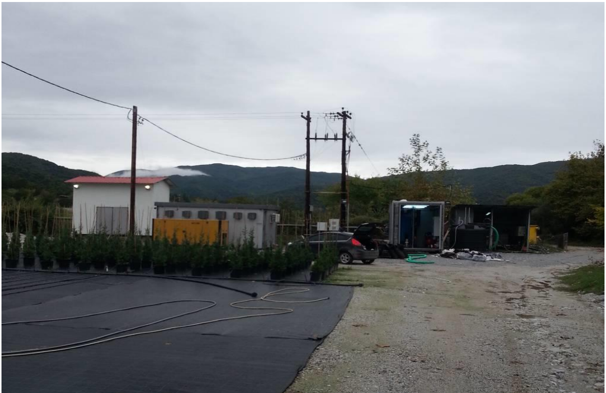
Φωτογραφία 6-4: Κοντινή άποψη του χώρου εγκατάστασης της πιλοτικής μονάδας για την πρόσθετη κατεργασία των νερών μεταλλείου Ολυμπιάδας
