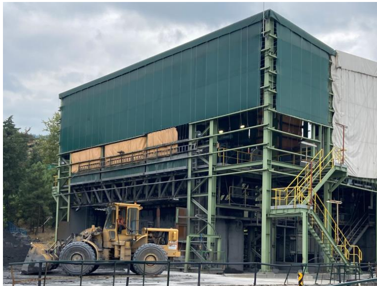
Φωτογραφία 5-5: Φιλτρόπρεσσα αφύγρανσης ιλύος κατεργασίας νερών Μεταλλείου Ολυμπιάδας
