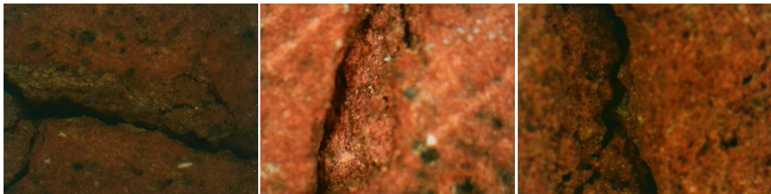
Εικόνα 27. Δείγμα 15. Ρωγμή (30x, 50x, 120x)
