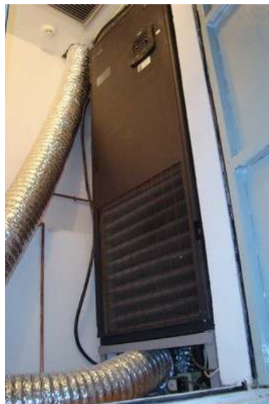
Φωτογραφία 4.6: Κλιματιστική Μονάδα
