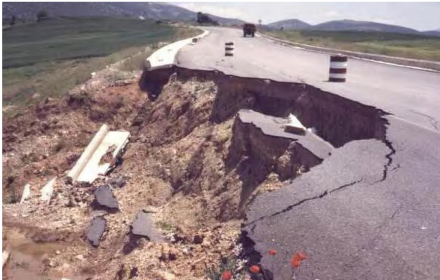
Εικόνα 15: Ολίσθηση οδοστρώματος επαρχιακής οδού Κοζάνης (2015).
