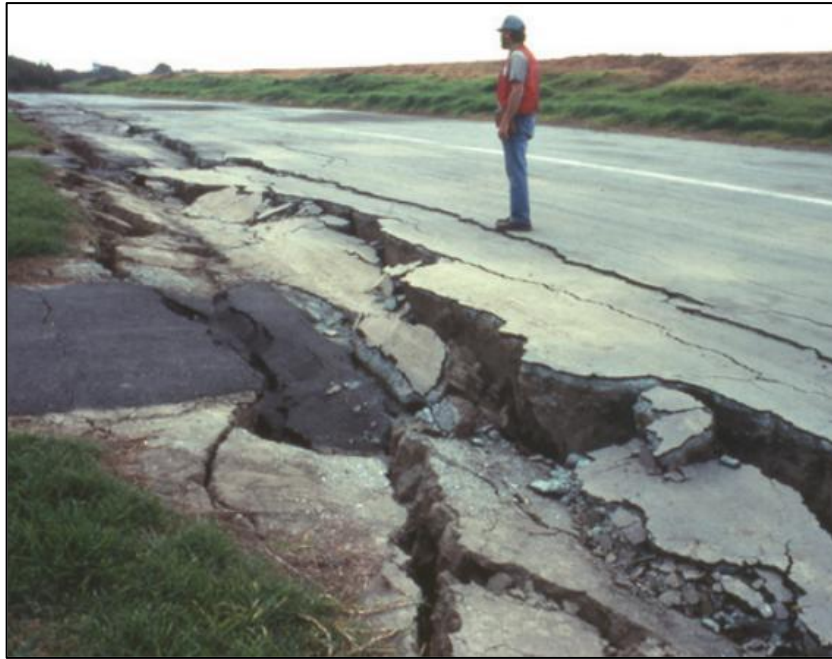
Εικόνα 28: Πλευρική Εξάπλωση σε δρόμο στην Καλιφόρνια, 1989 (US Geological Survey, 1989).
